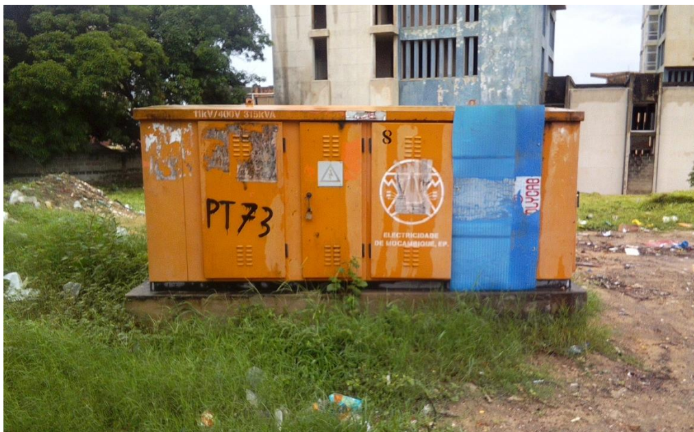
Figura 6: Posto de transformação em cabina baixa pré-fabricada
