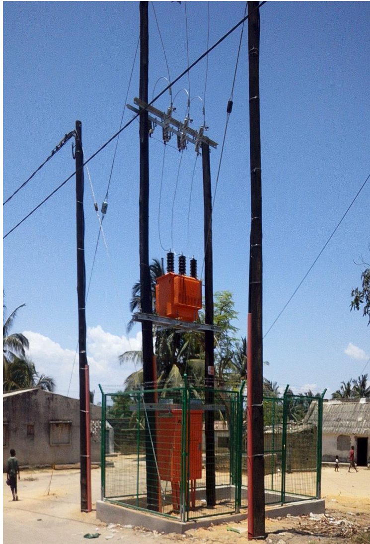
Figura 7: Postos de transformação aéreos
