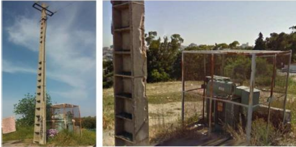
Figura 8: Posto de transformação em gaiola
