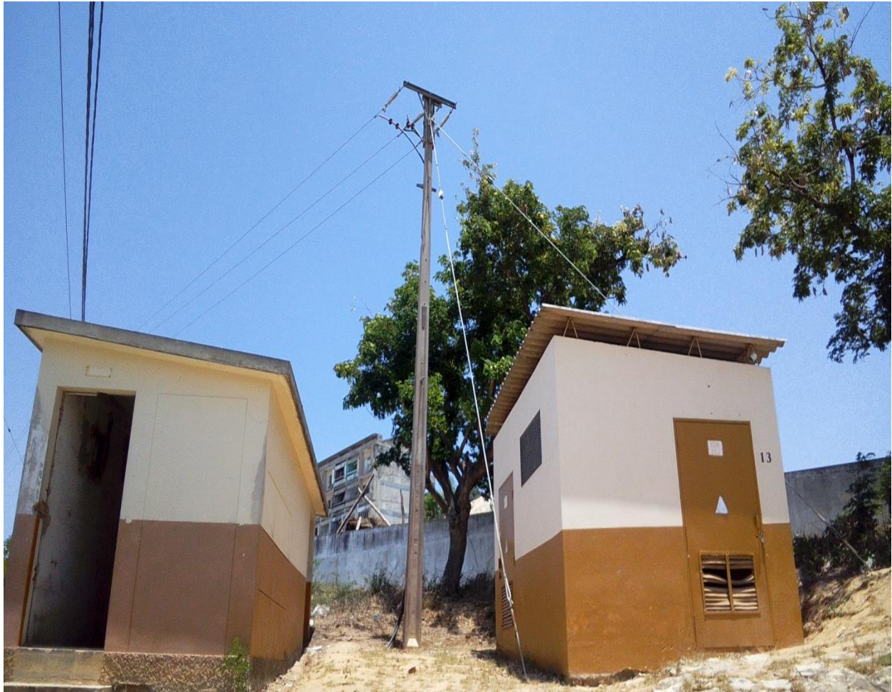
Figura 5: Postos de transformação em cabina baixa
