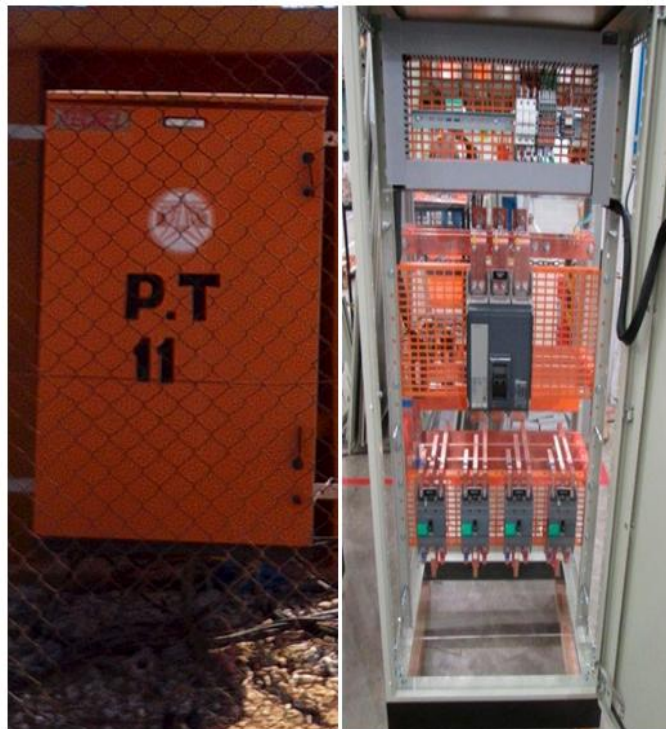
Figura 19: Quadro Geral de Baixa Tensão
