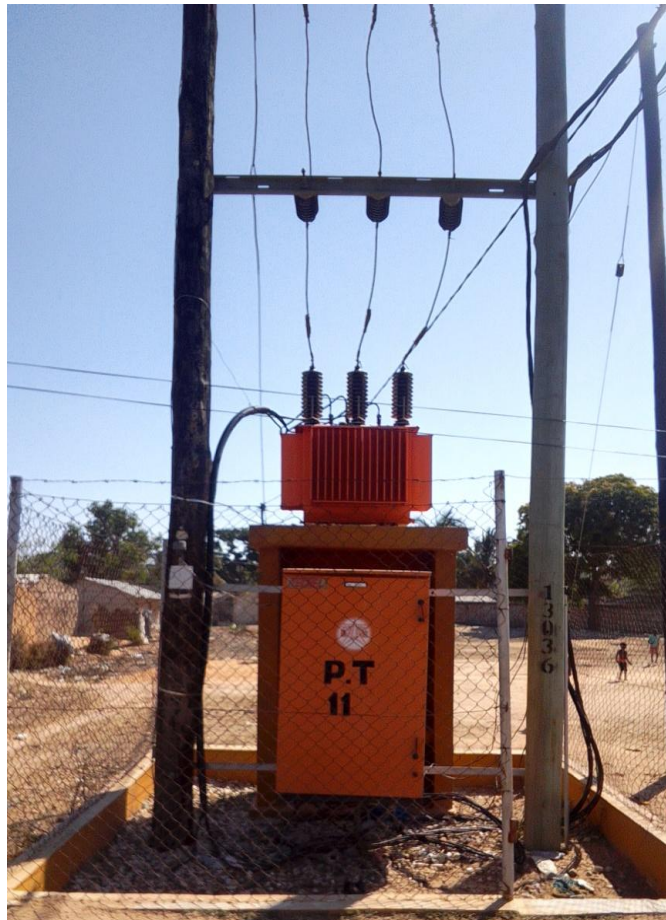
Figura 1: Posto de Transformação
