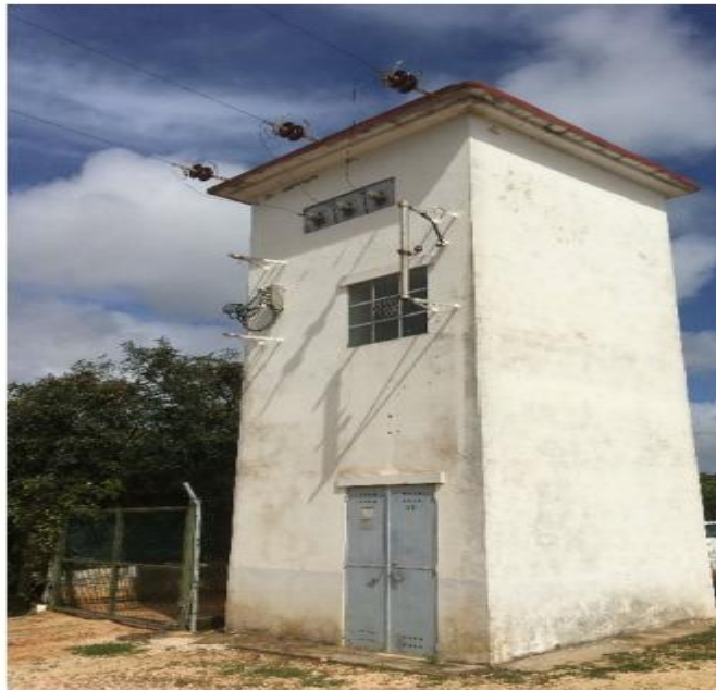
Figura 3: Posto de transformação em cabina alta
