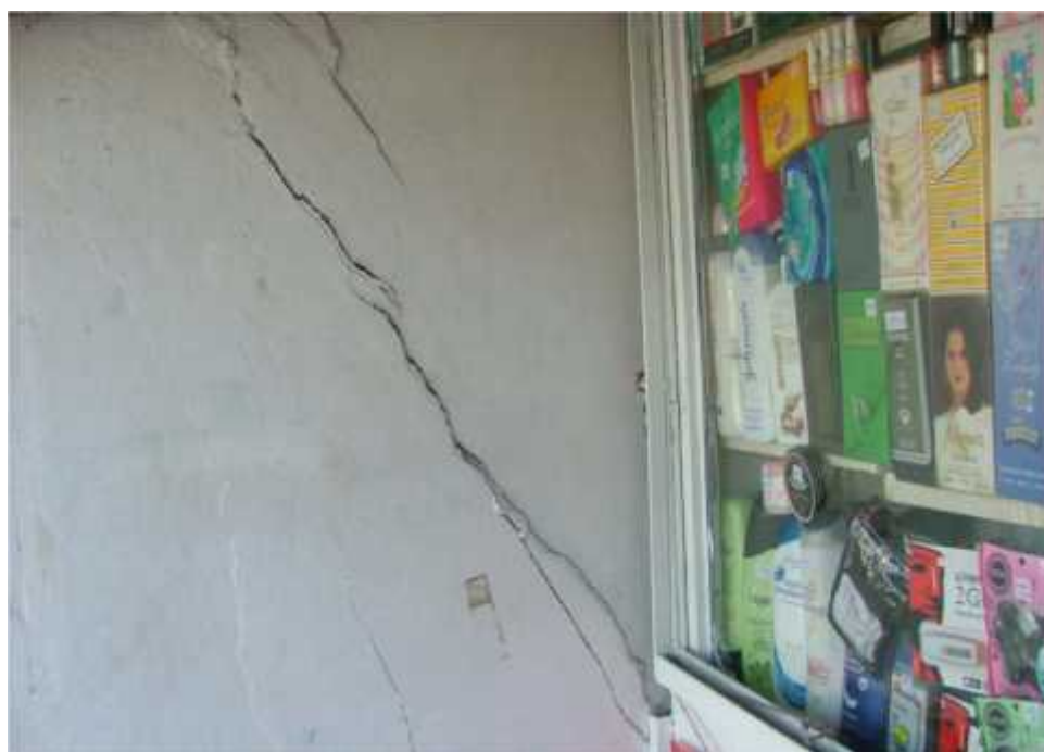
Figura 58 – Fissuração diagonal junto a parede contígua a tabacaria.
