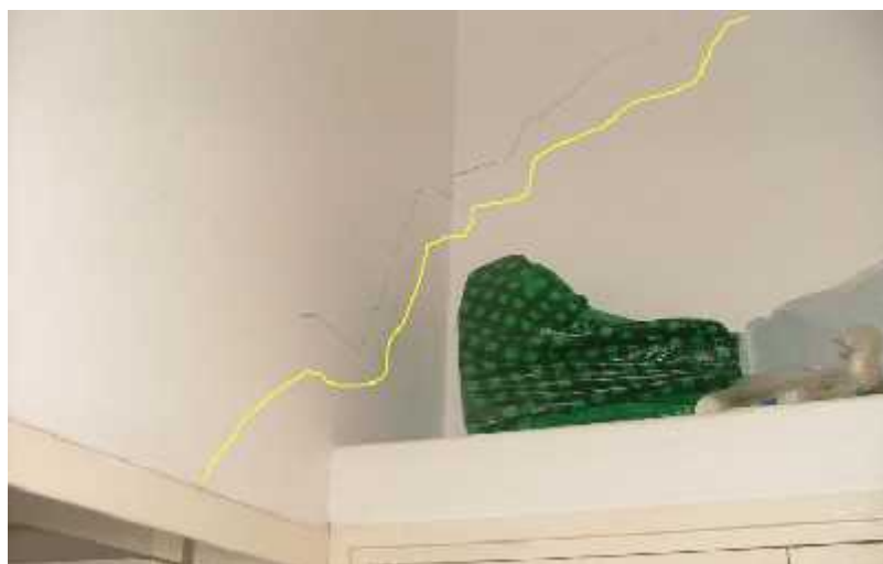
Figura 55 – Fissuração na parede do quarto.
