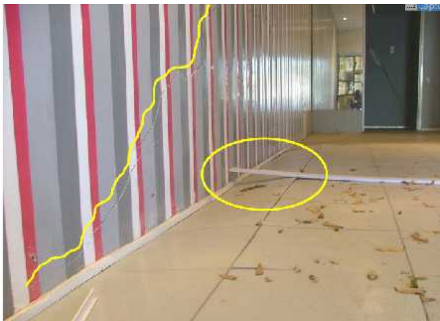
Figura 35 - Deformação excessiva do piso e fissuração acentuada da parede.
