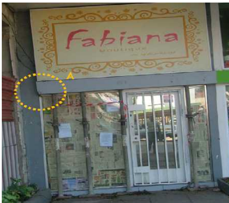
Figura 28 – Deformação excessiva do piso.
