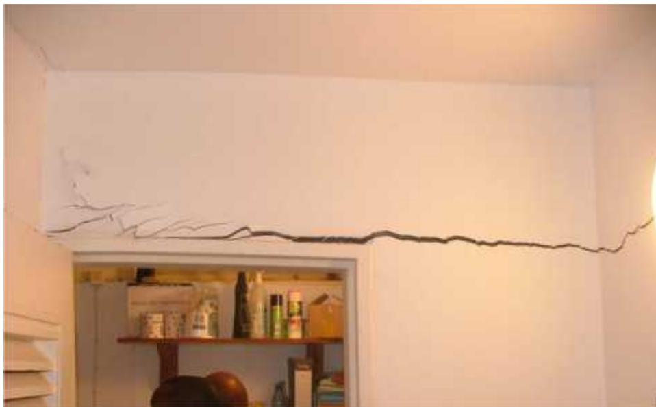
Figura 47 – Fissuração horizontal acentuada ao longo da parede.
