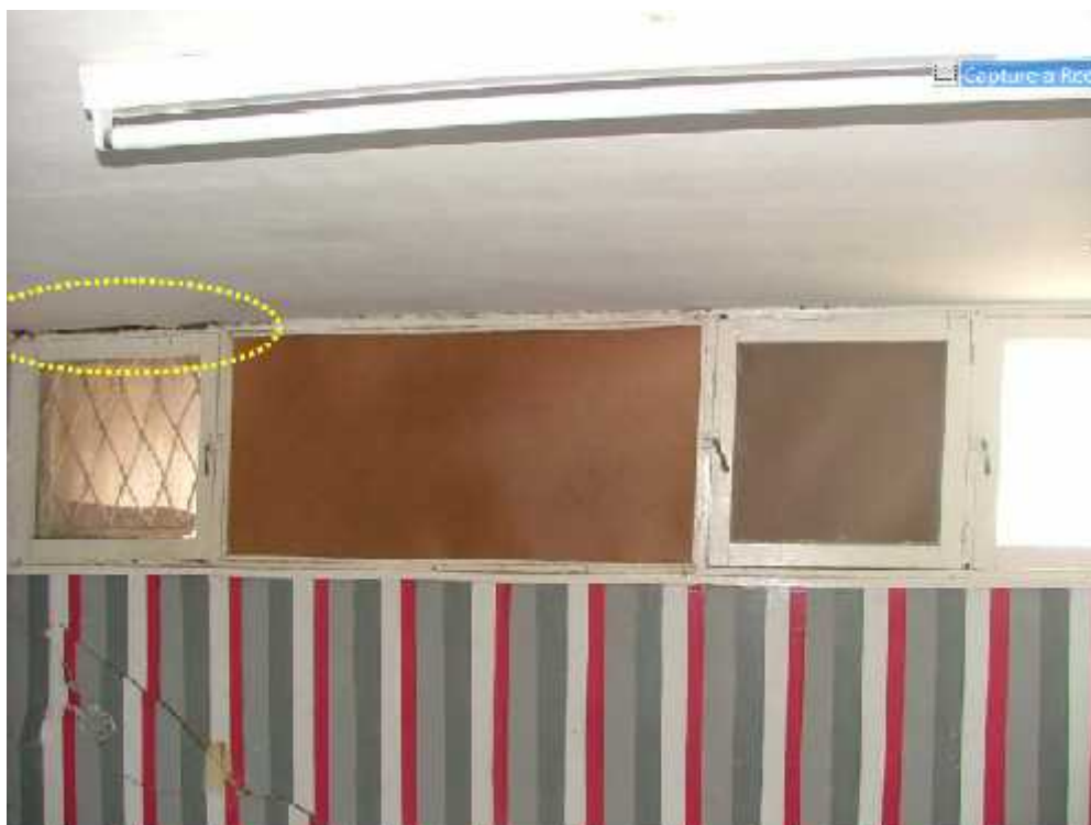
Figura 39 – Separação por empenamento da laje de cobertura e a caixaria de madeira.
