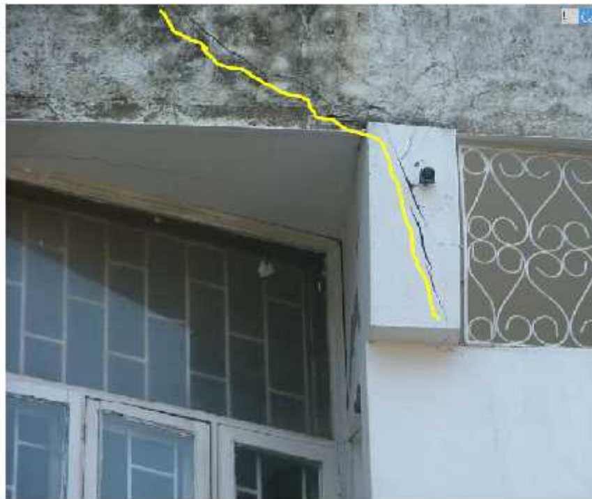
Figura 33 – Fissuração atravessando elementos resistentes da estrutura e o aspecto das machas e fungos presentes em alguns locais das paredes.
