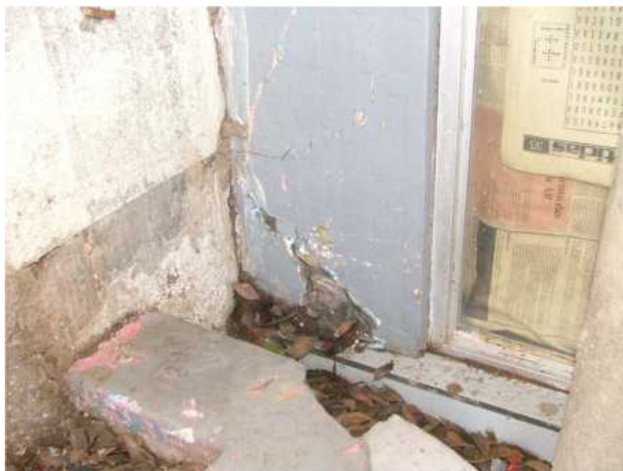
Figura 30 - Fissuração pontual junto a base do pilar localizado junto a nova construção.
