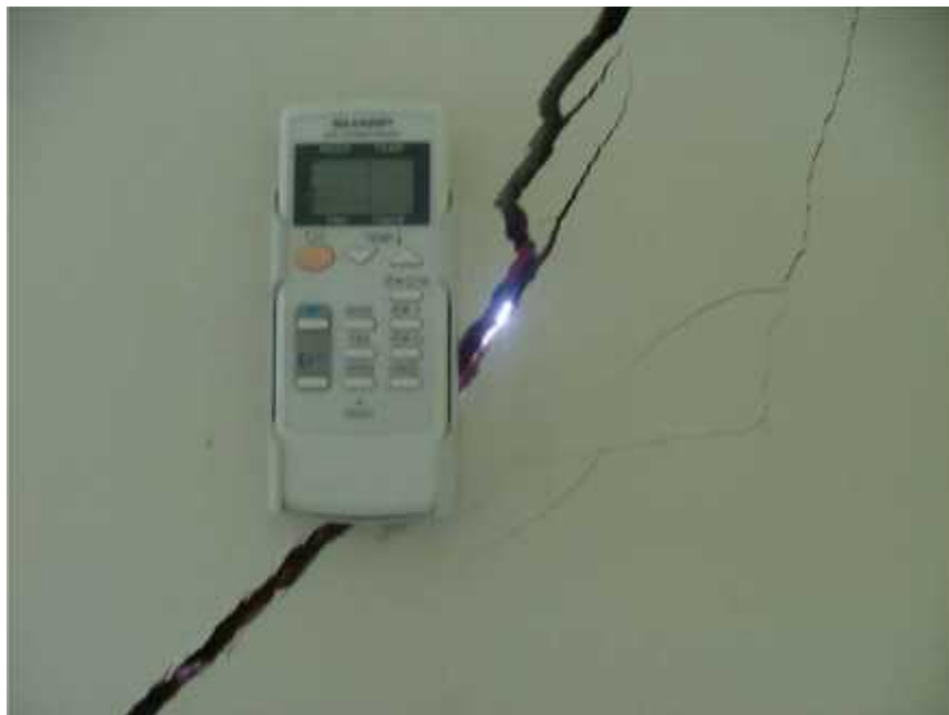
Figura 54 – Fissuração acentuada que atravessa toda a espessura da parede da sala.
