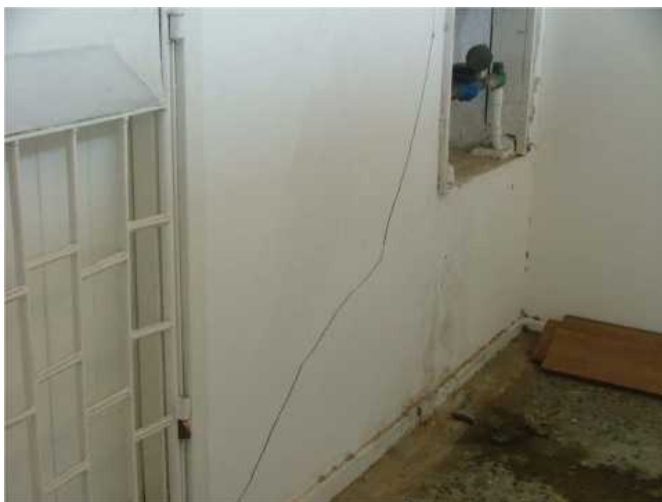
Figura 64 – Fissuração diagonal das paredes.
