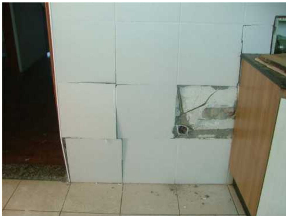
Figura 50 – Fissuração da parede da cozinha acompanhada de destacamento do revestimento.
