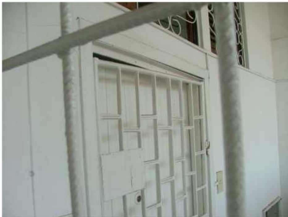
Figura 63 – Empenamento da caixilharia das portas.
