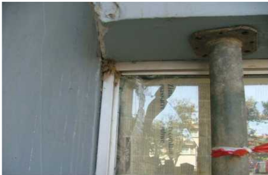
Figura 29 – Rotura da fachada envidraçada por deformação excessiva do piso (pormenor A).
