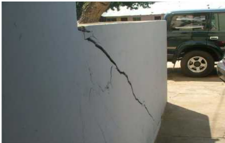
Figura 31 – Fissuração acentuada de um muro em betão armado junto a saída das escadas de acesso as traseiras do edifício, sendo pontualmente visíveis as armaduras.
