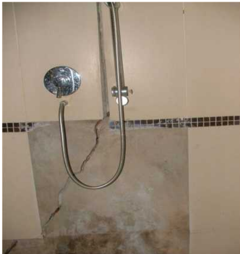
Figura 51 – Fissuração da parede da casa de banho acompanhada de destacamento do revestimento
