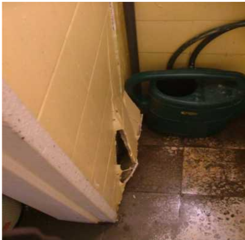
Figura 45 – Rotura do revestimento interior das paredes da casa de banho.
