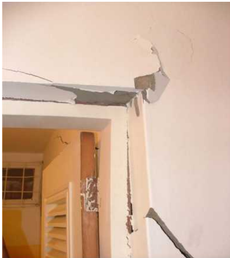
Figura 44 – Fissuração acentuada acompanhada de desalinhamento de paredes.
