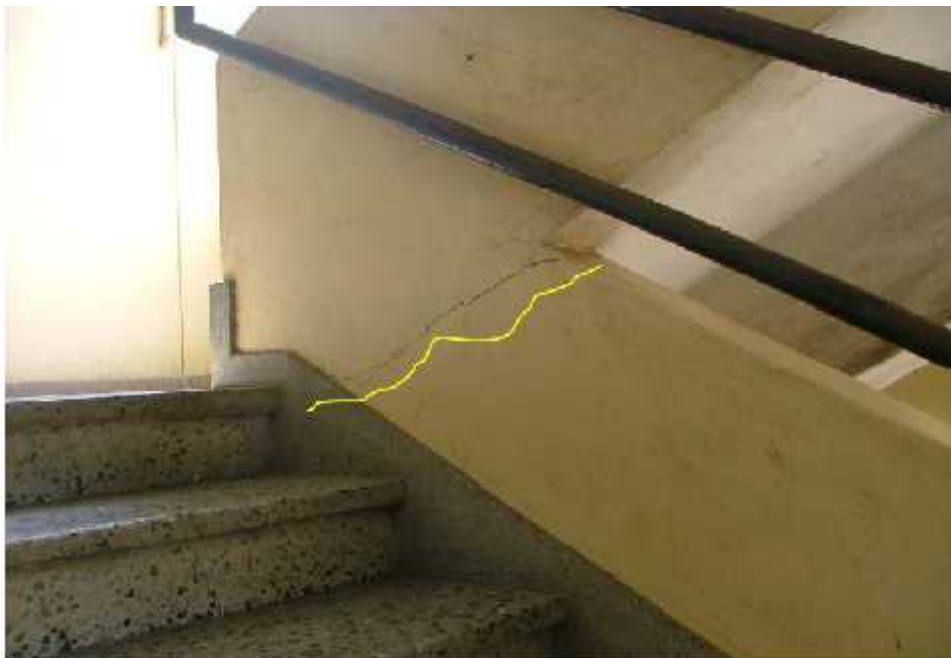
Figura 60 – Fissuração do muro das escadas, repetindo-se em quase todos os pisos.
