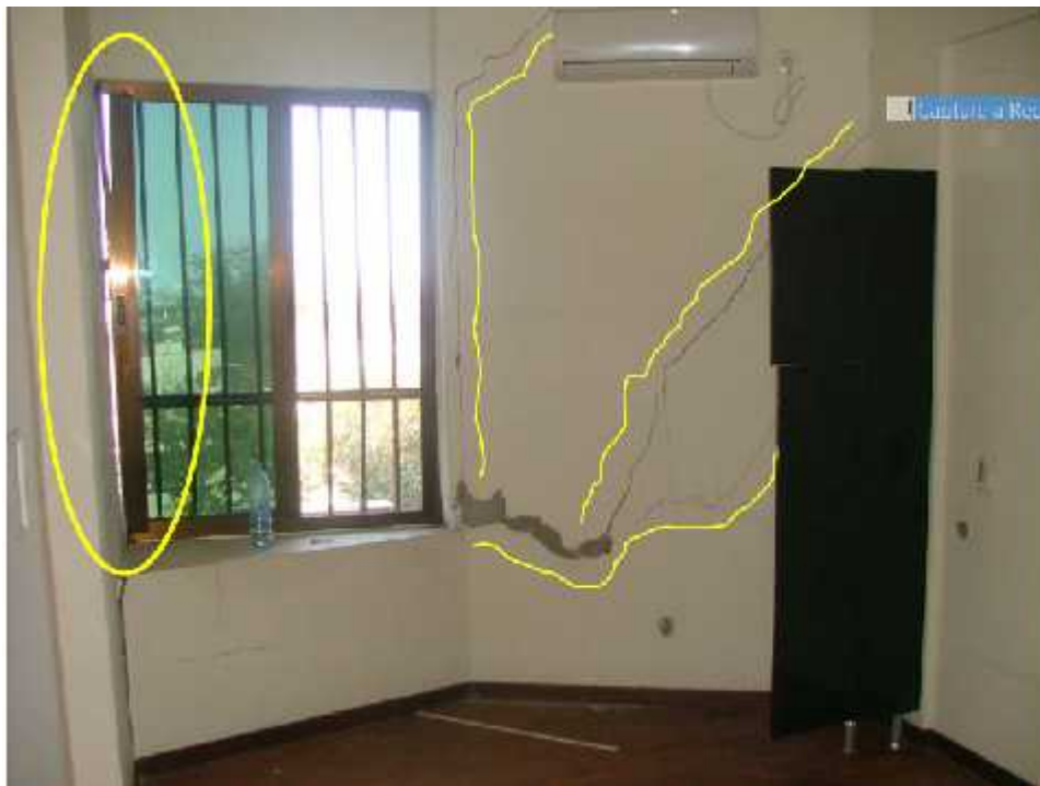
Figura 52 – Fissuração acentuada da parede do quarto e separação da caixilharia da parede.
