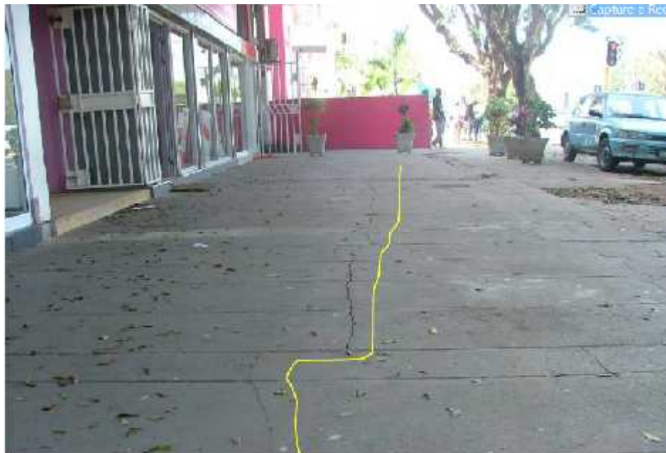
Figura 27 – Fissuração do passeio, desenvolvendo-se paralelamente a fachada frontal do edifício.
