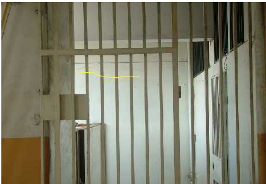
Figura 66 – Fissuração horizontal na parede junto ao Apart. 04.
