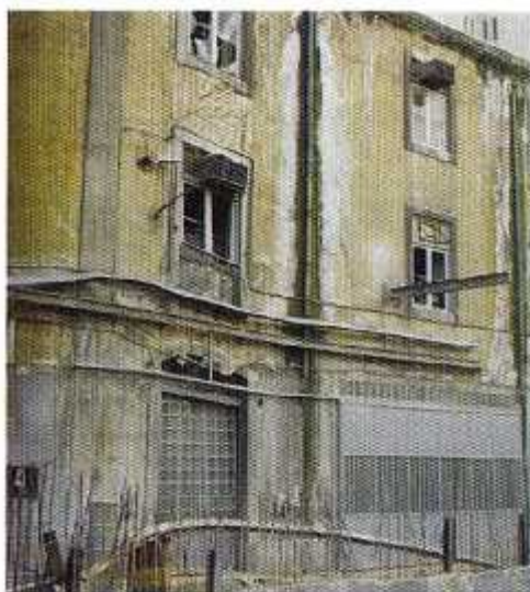
Figura 7 - Conseqüência do rebaixamento do nível freático associado a descompressão do terreno (Appleton.J, 2003).
