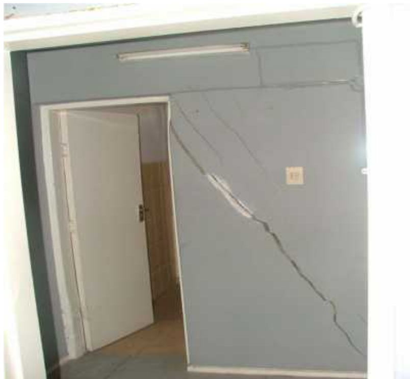
Figura 40 – Fissuração acentuada das paredes de alvenaria.
