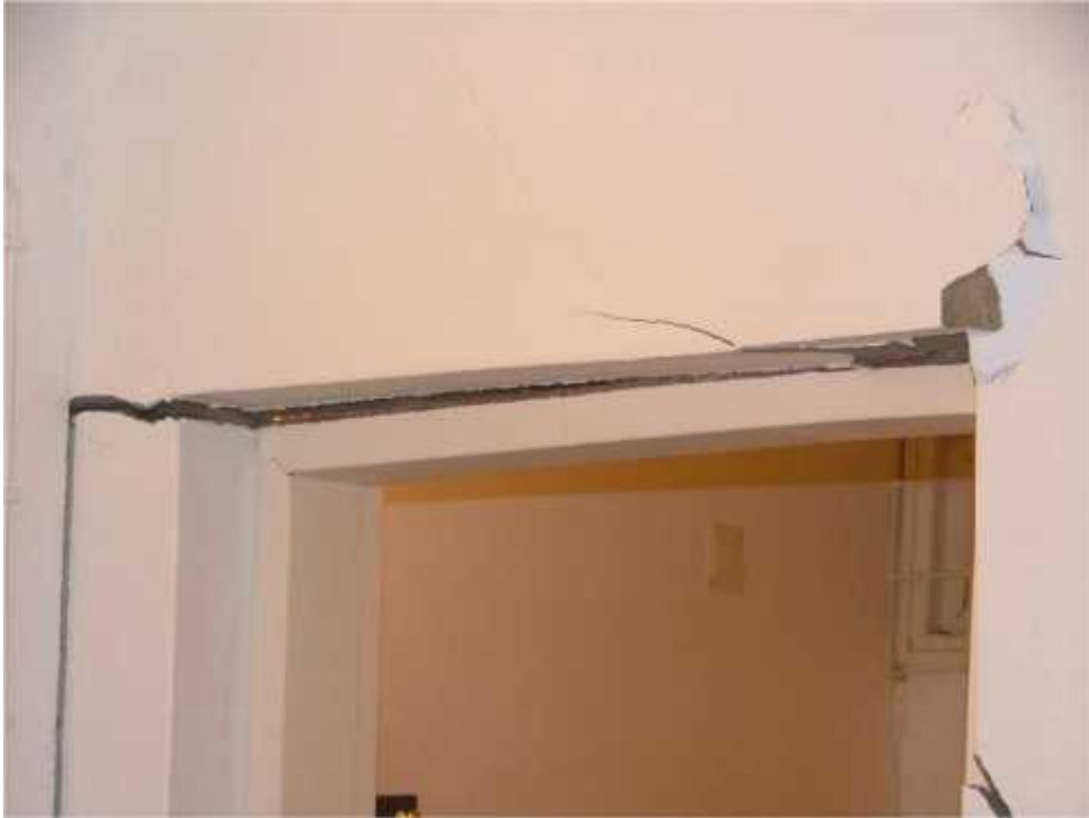
Figura 42 – Fissuração acentuada com tendência à separação de elementos de construção.
