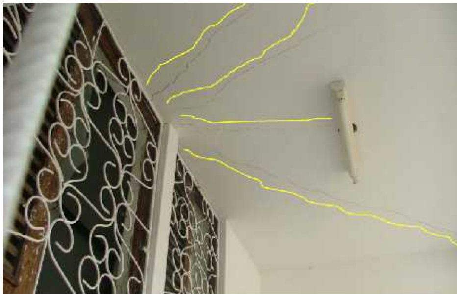
Figura 65 – Fissuração da laje do tecto.
