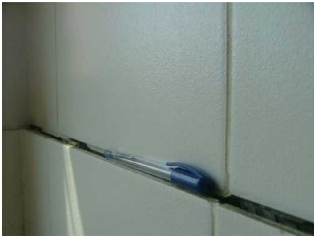
Figura 49 – Fissuração da parede da cozinha acompanhada do desalinhamento do revestimento.
