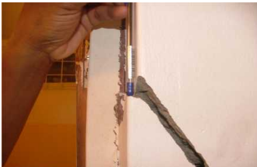
Figura 46 – Pormenor da fissuração acentuada acompanhada de desalinhamento de paredes.
