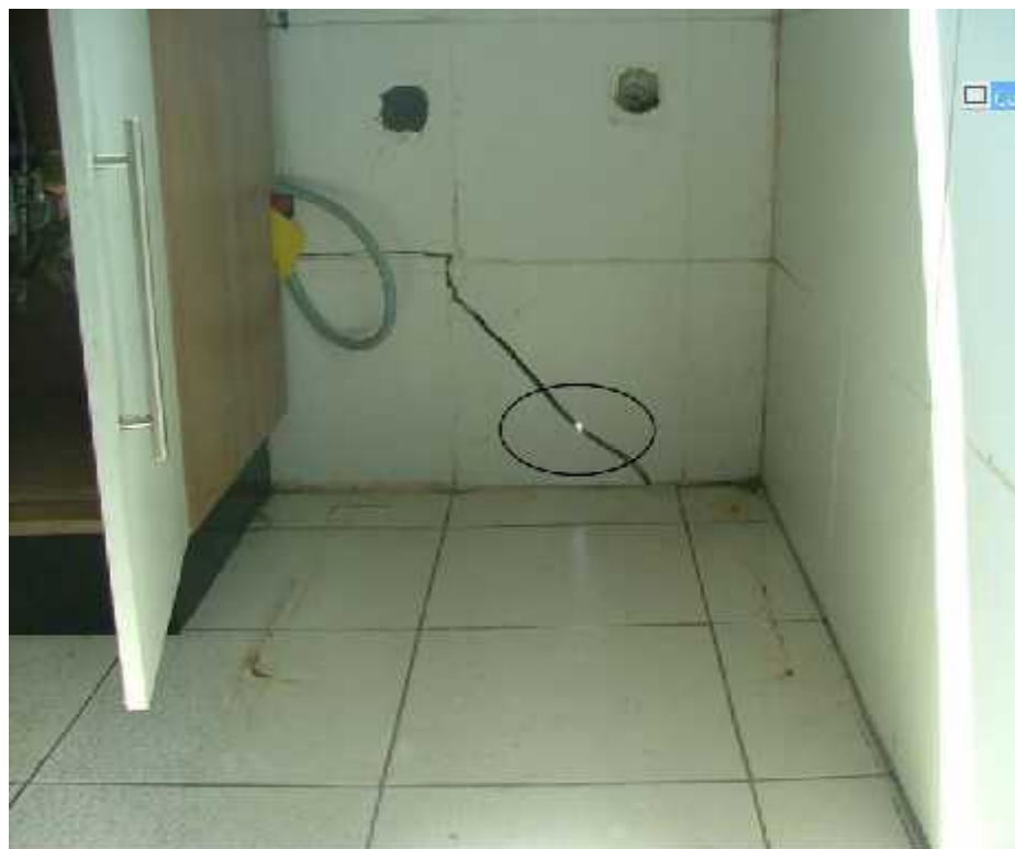
Figura 48 – Fissuração na parede da cozinha atravessando a espessura da parede.
