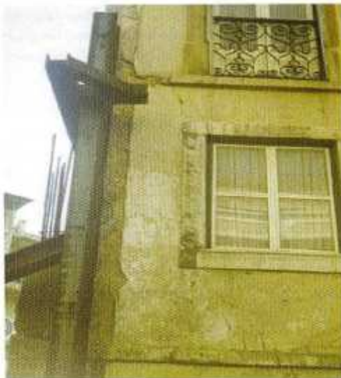
Figura 8 - Assentamento de fundação devido a descompressão do solo, na sequência de escavação adjacente (Appleton.J, 2003)
