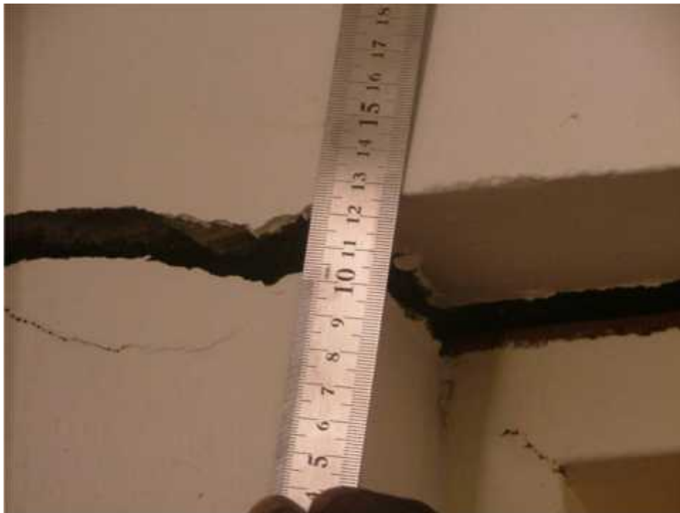
Figura 43 – Pormenor da fissuração acentuada (abertura 20mm).
