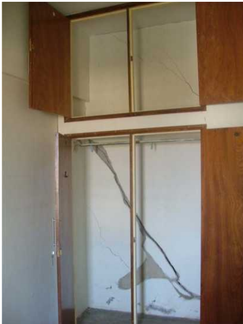
Figura 53 – Fissuração acentuada no interior dos guarda-fatos.
