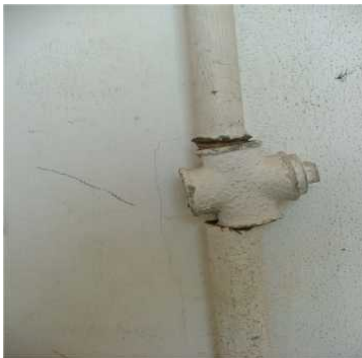
Figura 34 – Degradação dos tubos de queda e das respectivas fixações.
