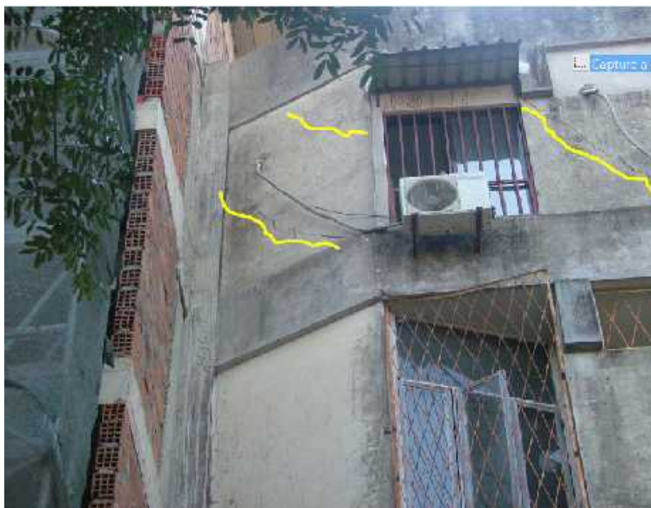
Figura 32 – Fissuração das paredes de alvenaria.
