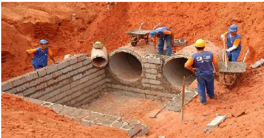
Figura 4: Caixa de visita
