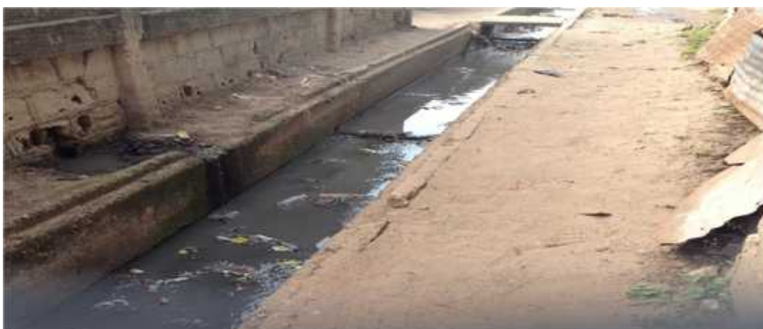
Figura 9: Despejo de águas residuais domésticas na vala de drenagem de águas pluviais. Bairro da Mafalala
