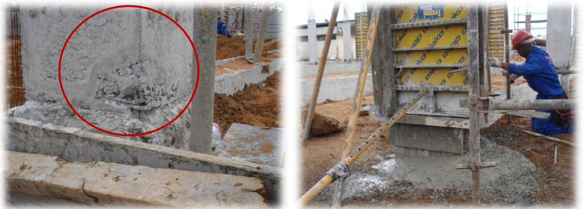
Fig. 44 -Segregação do betão e armadura a vista, resultado de abertura nas peças de cofragem e ignorância no uso de bloquetes/espessadores.
