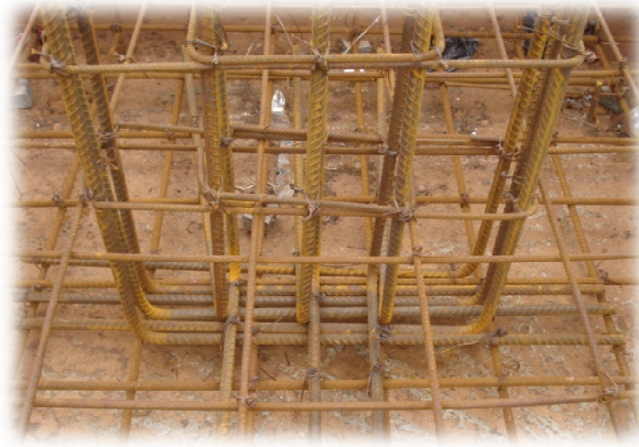
Fig.45 -Concentração excessiva de armadura em arranque de pilar
