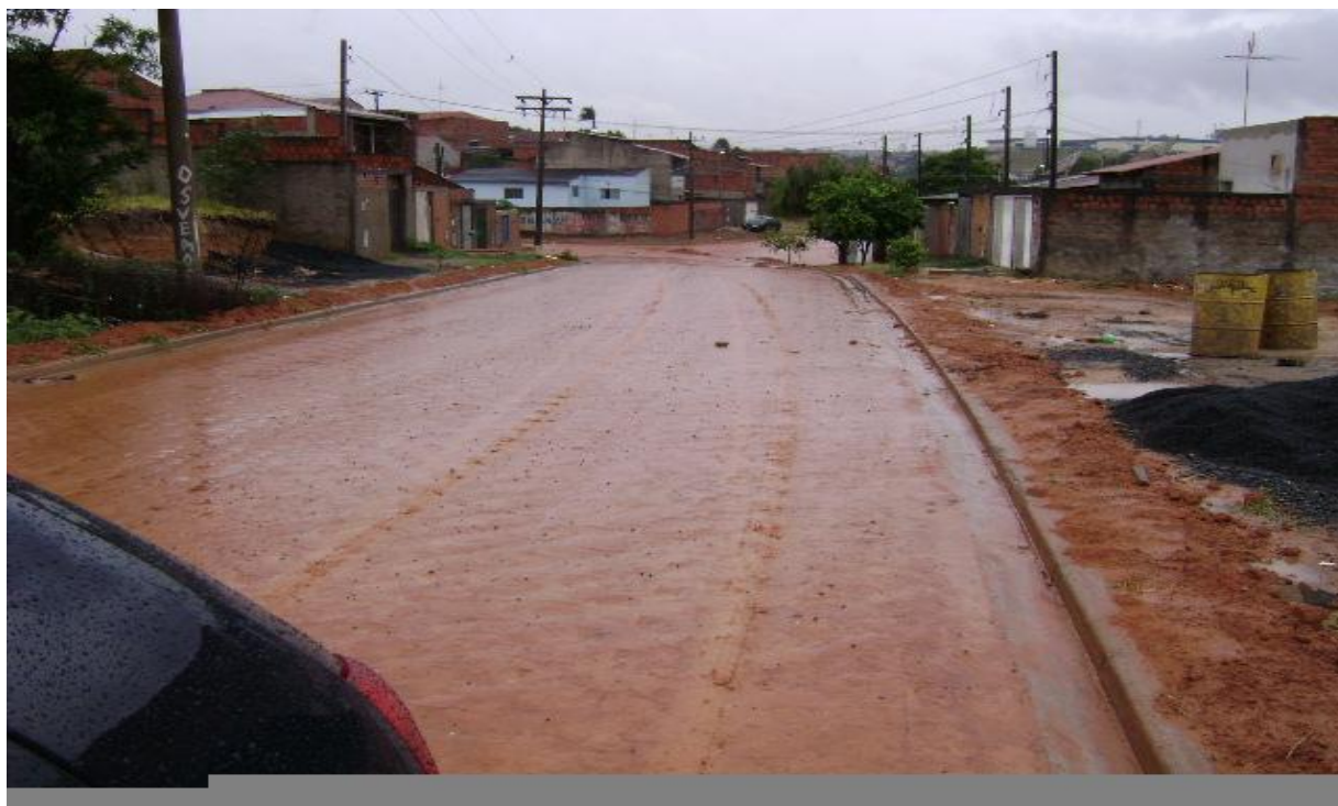
Figura 9 – Pavimento estabilizado com aditivo HomysoloGb em tempo húmido Fonte: ROESSLER, 2016, Manual de laboratório IQSCTC
