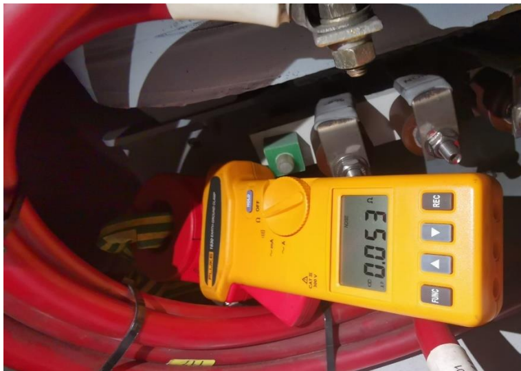
Figura 22.: Resultado da medição da resistência de aterramento feita no terreno.
