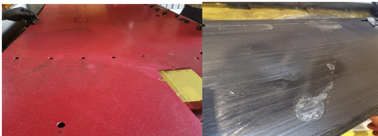
Figura 23.: Vestígios de infiltração de água para o transformador.
