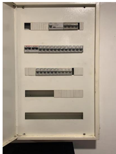
Figura 10: Quadro de distribuição da sala de formação.
