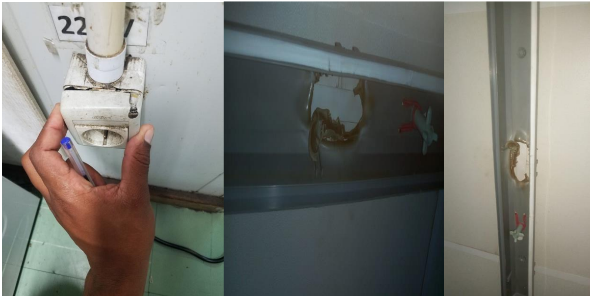
Figura 3: Tomadas e suporte de lâmpadas danificadas.
