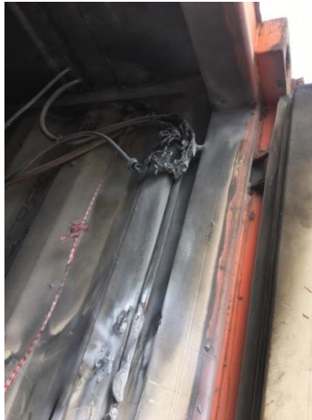
Figura 7: Quadro de derivação e cabos queimados devido a um curto circuito.
