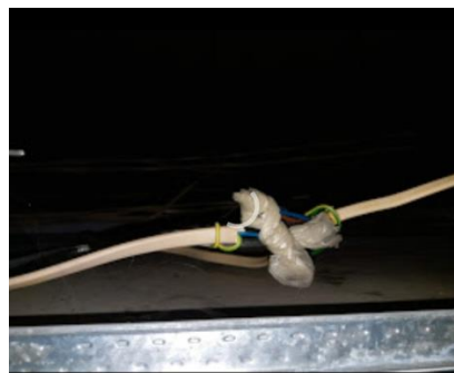
Figura 8: Cabos com baixo nível de isolamento.
