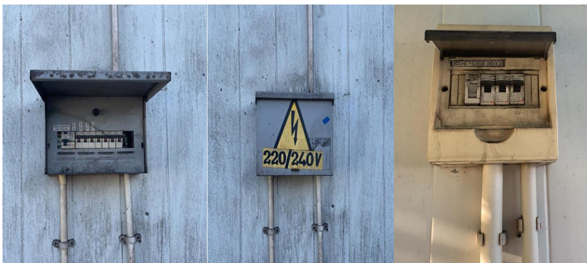
Figura 12: Quadros de distribuição com baixo índice de proteção.
