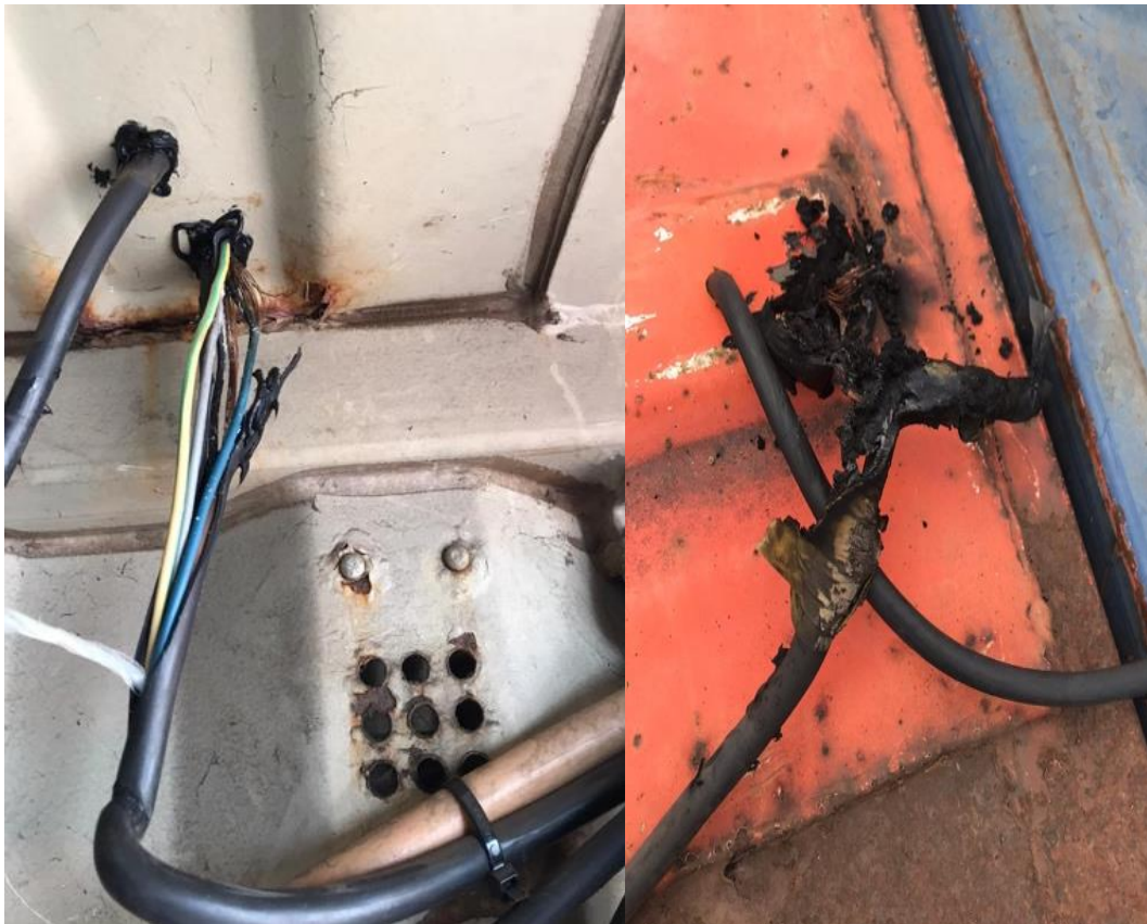
Figura 6: Cabos queimados devido a um curto circuito.
