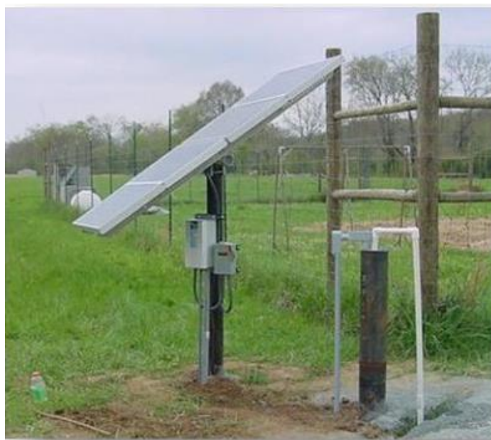
Figura 12: Sistema de bombeamento fotovoltaico.
