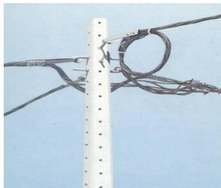
Figura 5. Rede Eléctrica de B.T em Cabo Torçado
