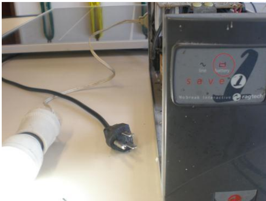
Figura 22: No-break operando sem fornecimento da rede
