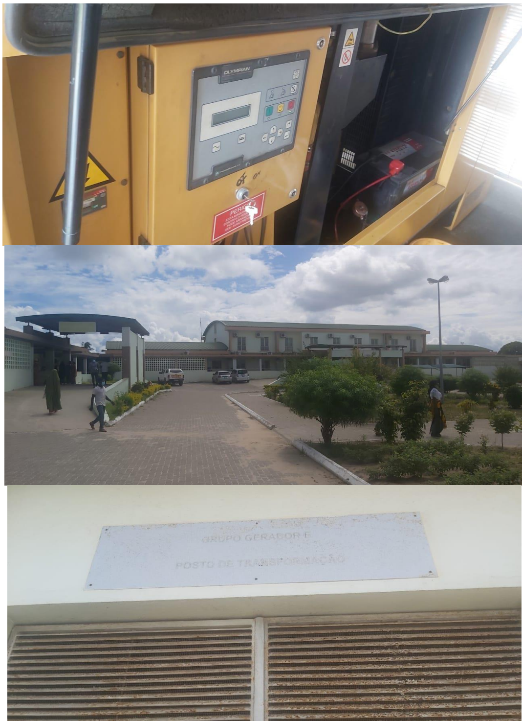
Grupo de Gerador a diesel, vista frontal do HDN e o Bloco do sistema de gerador a diesel.
