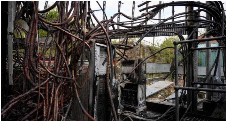
Figura 20: Infra-estrutura vandalizada em Huddersfield, norte da Inglaterra
