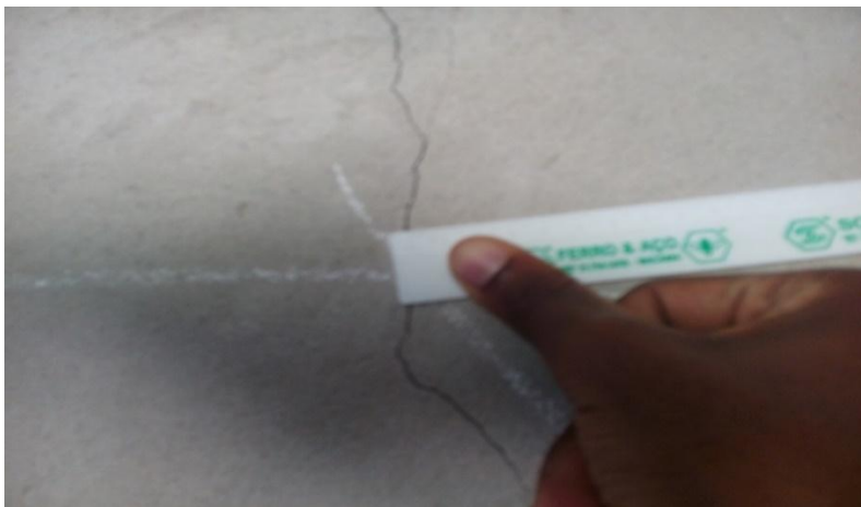
Figura 24. Medições de fissuras.
