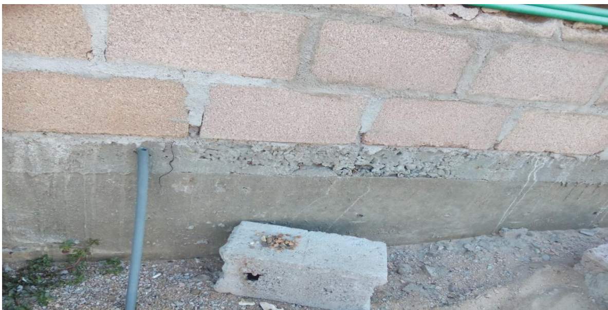
Figura.17. Segregação do betão por deficiente vibração do betão fresco.
