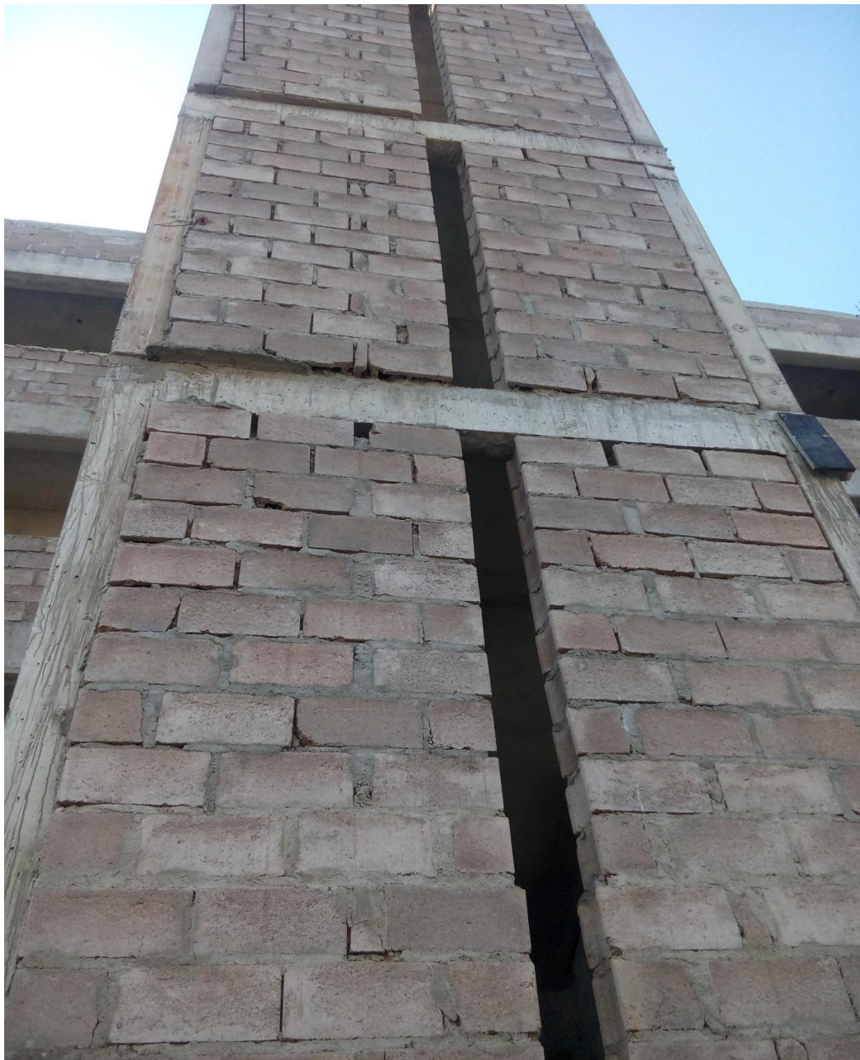
Figura.21. Alvenaria não alinhada da estrutura na tentativa de corrigir a esquadria, podendo ter as suas consequências futuras.
