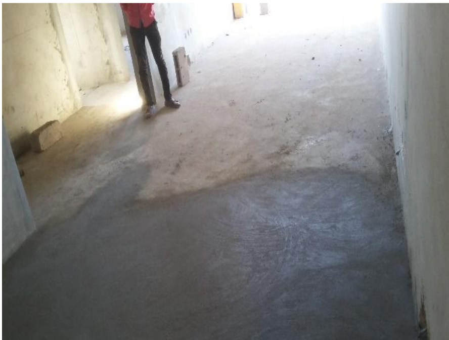
Figura.31. Rectificação da betonilha, tinha desnível e alisamento sem qualidade.
