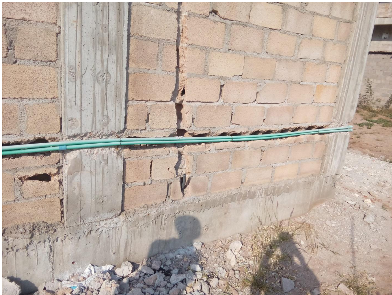
Figura.37. Tubagem exposta, por um período relativamente longo podendo degradar-se por radiação solar.
