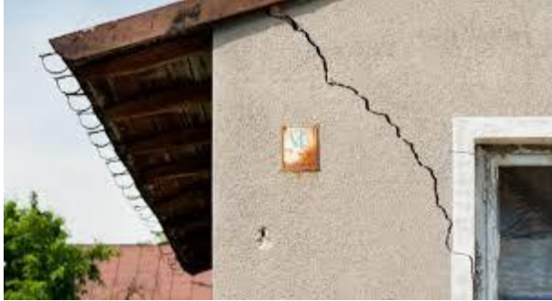
Figura.5. Exemplo de Rachadura: superior a 1,5 mm (NBR 9575:2003).
