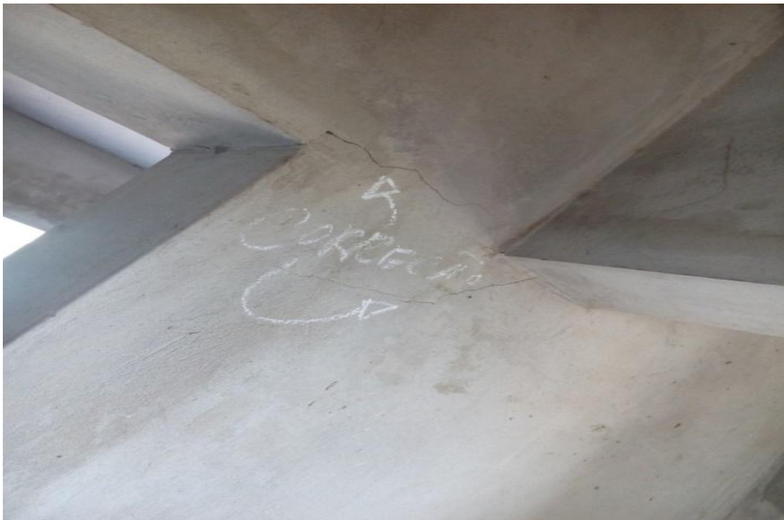
Figura. 13. Fendilhação por cargas.
