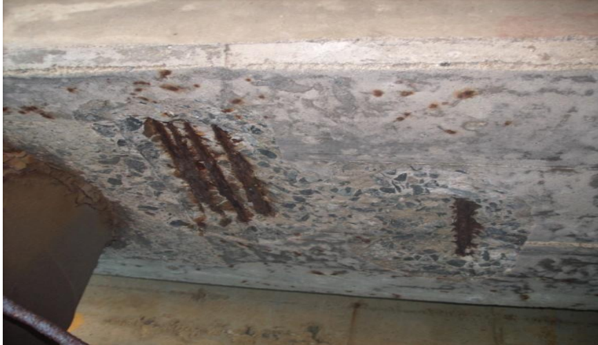
Figura.6. Corrosão de armaduras devido ao recobrimento menor.
