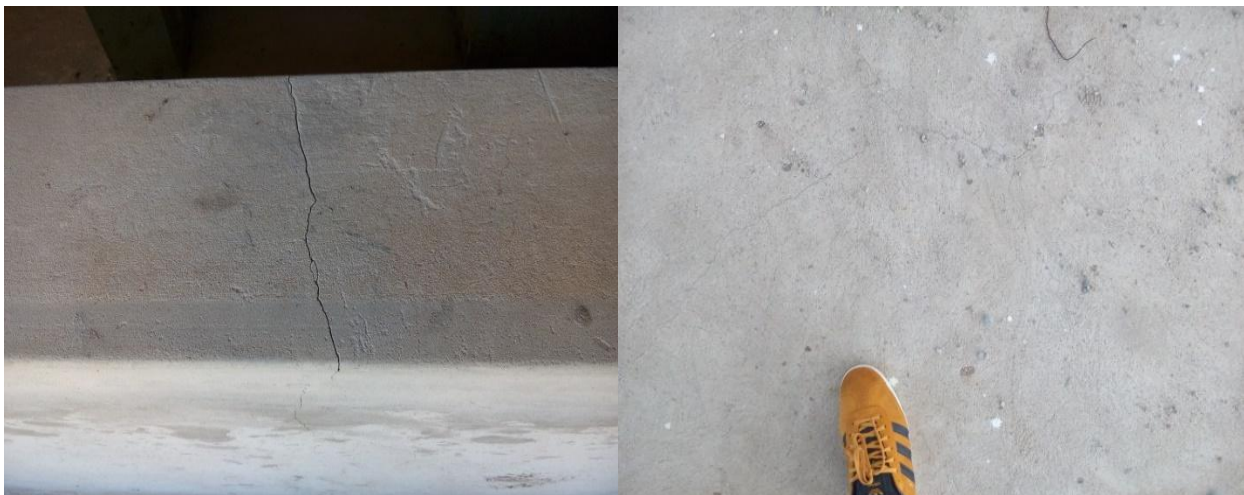
Figura.12. fendilhação por retracção da argamassa.
