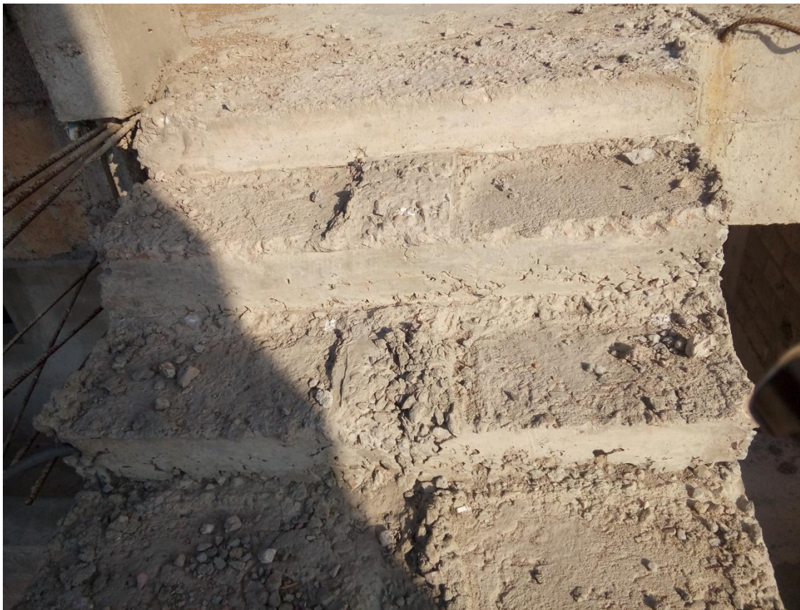
Figura.19. Pilar suspenso betonada acima do nível do solo e a escada com cofragem deficiente e colocação do betão.
