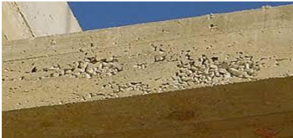
Figura.3. betão segregado (Segundo Piancastelli).
