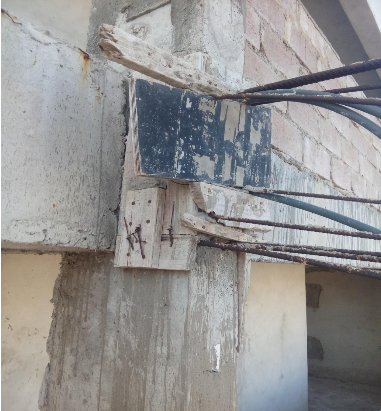
Figura.20. Madeira exposta resultante da má cofragem e armadura exposta sujeita a corrosão.
