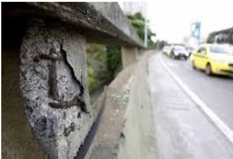
Figura.7. Degradação do betão (Segundo Miotto).
