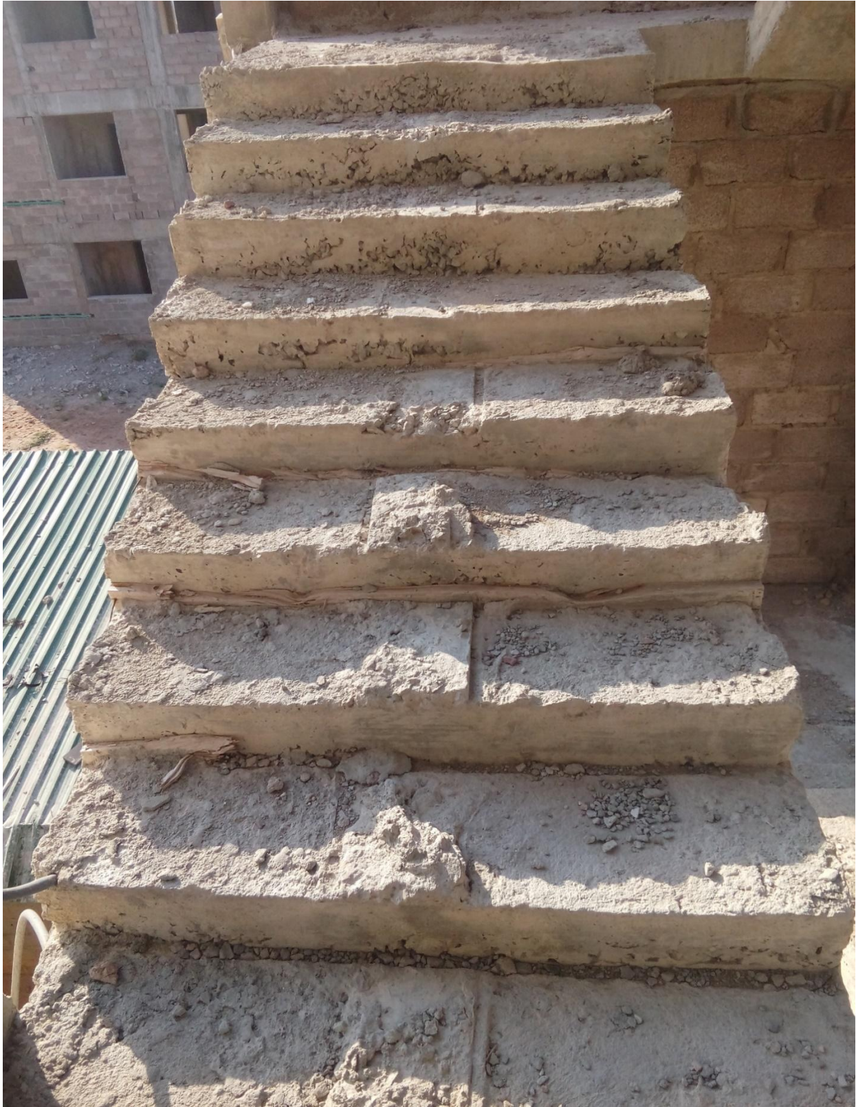
Figura. 25 (a) e (b). Cofragem deficiente e dimensões irregulares dos degraus o que pode implicar maior reboco em certos degraus.
