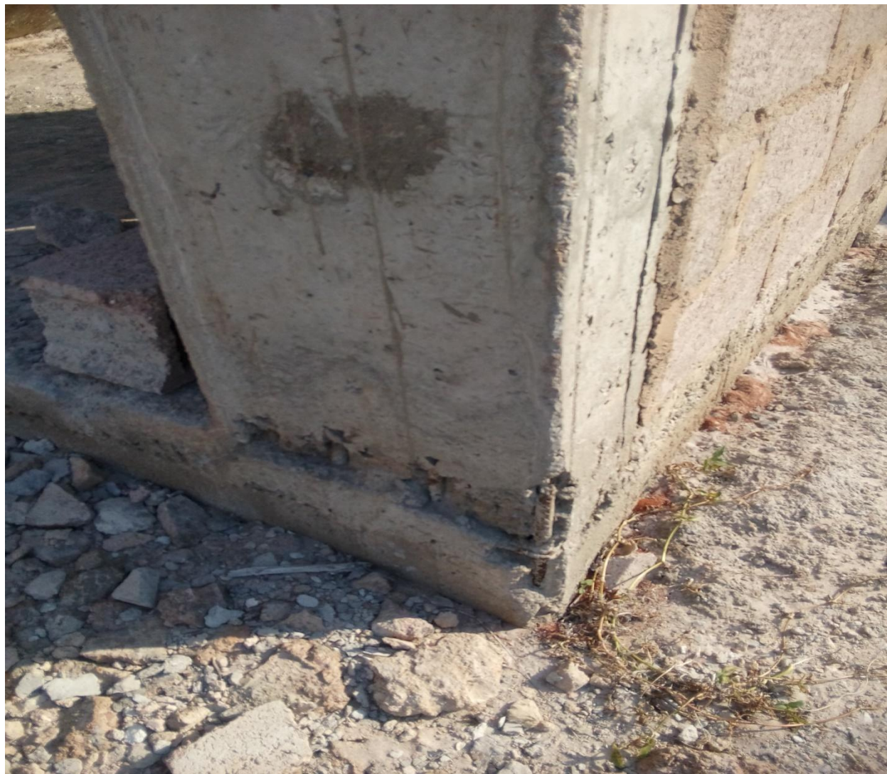
Figura.36. Armadura exposta na base do pilar.
