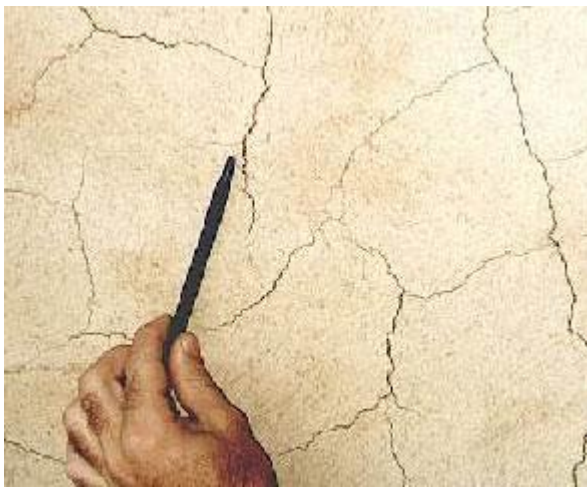
Figura.4. Fissura: abertura de até 0,5 milímetro (NBR 9575:2003).
