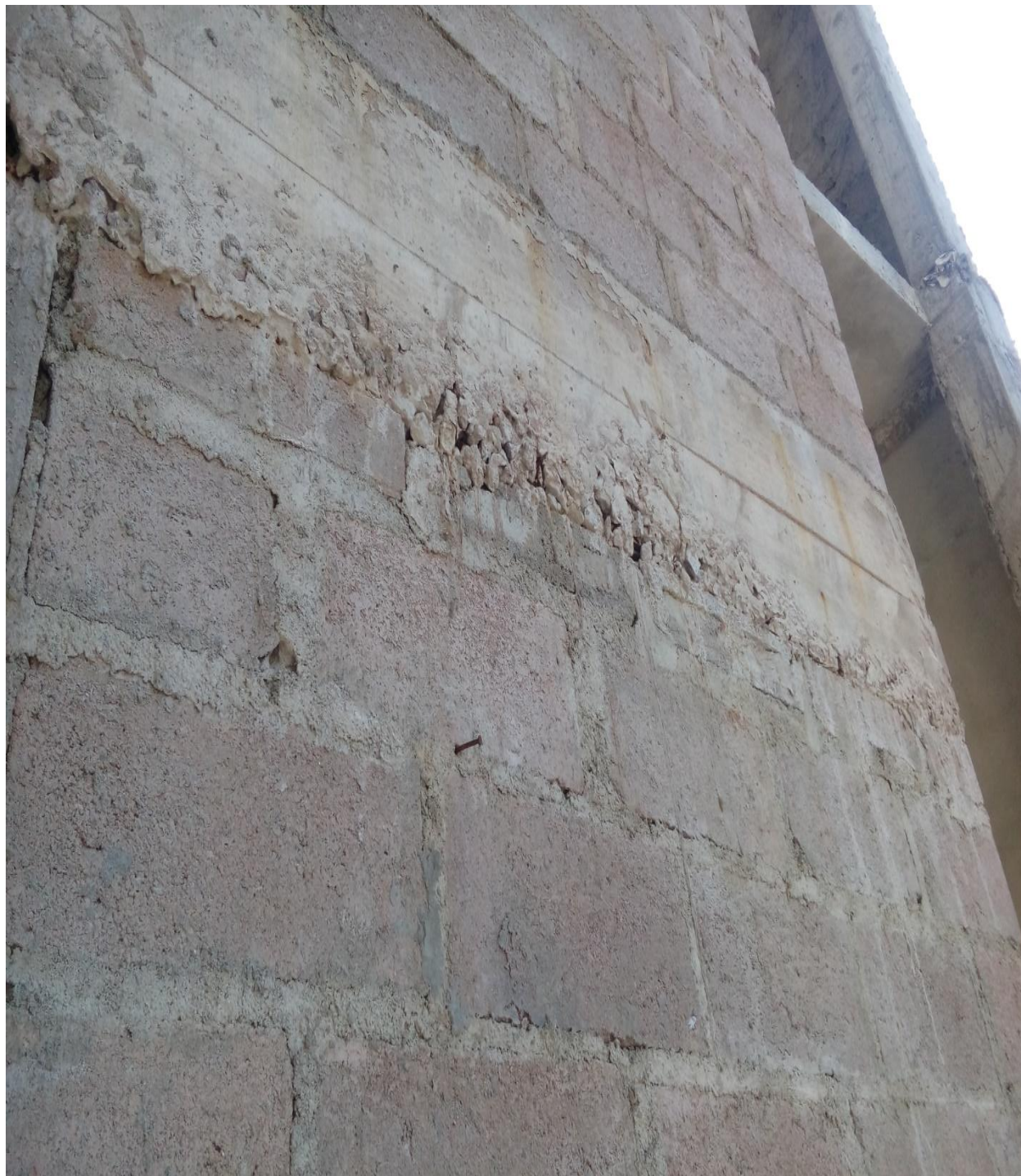
Figura.35. Viga com betão segregado.
