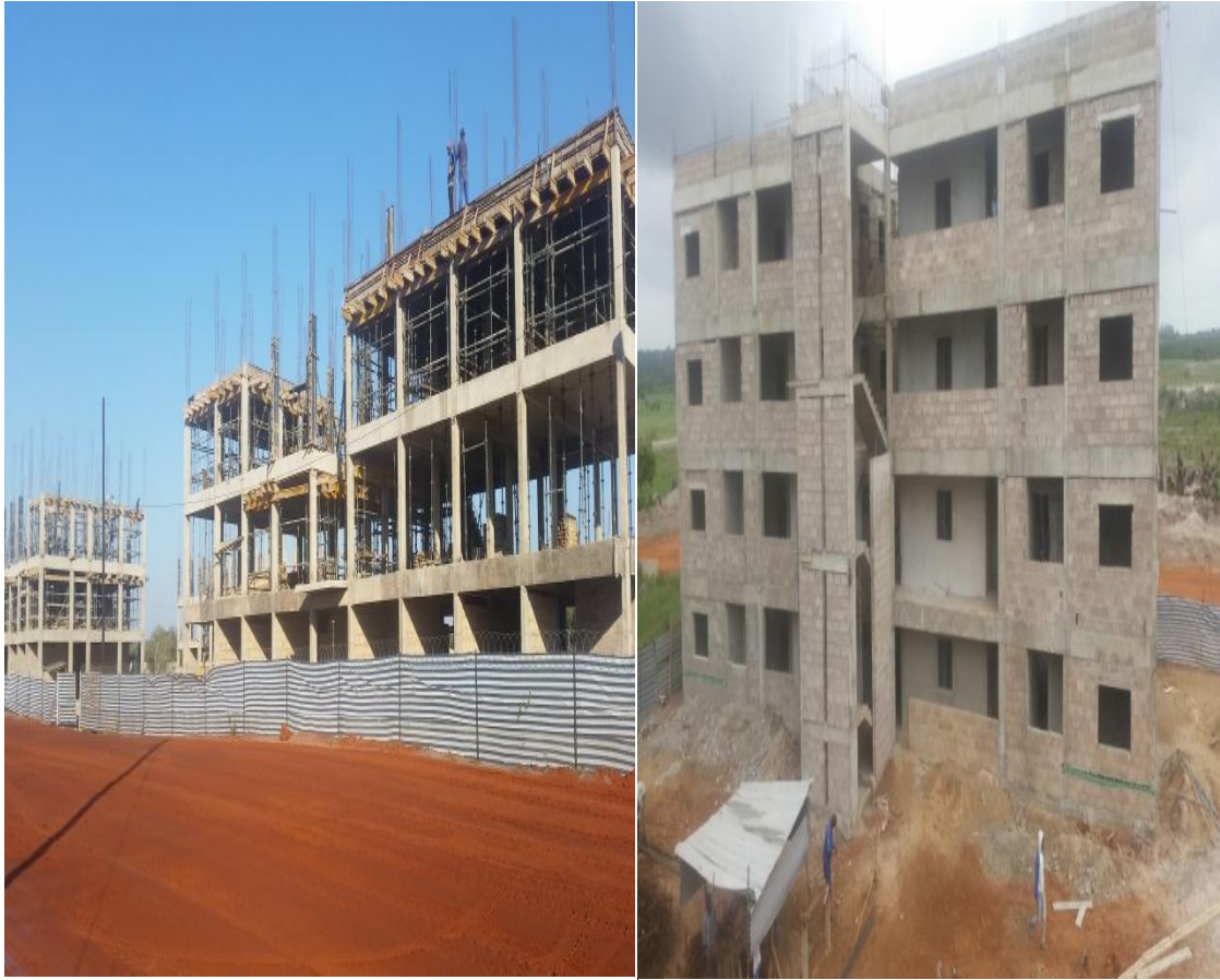
Figura.8. Edifícios de 5 pisos com 4 apartamentos T2 e T3 em 4 pisos e o 5 è um terraço não acessível.
