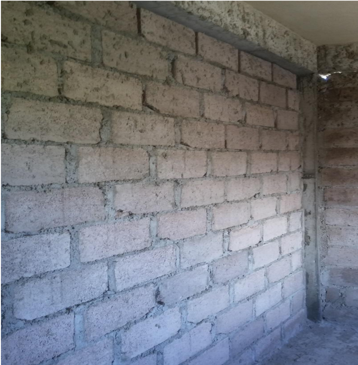
Figura.16. Falta de concordância do alinhamento da parede com a Viga e pilar.
