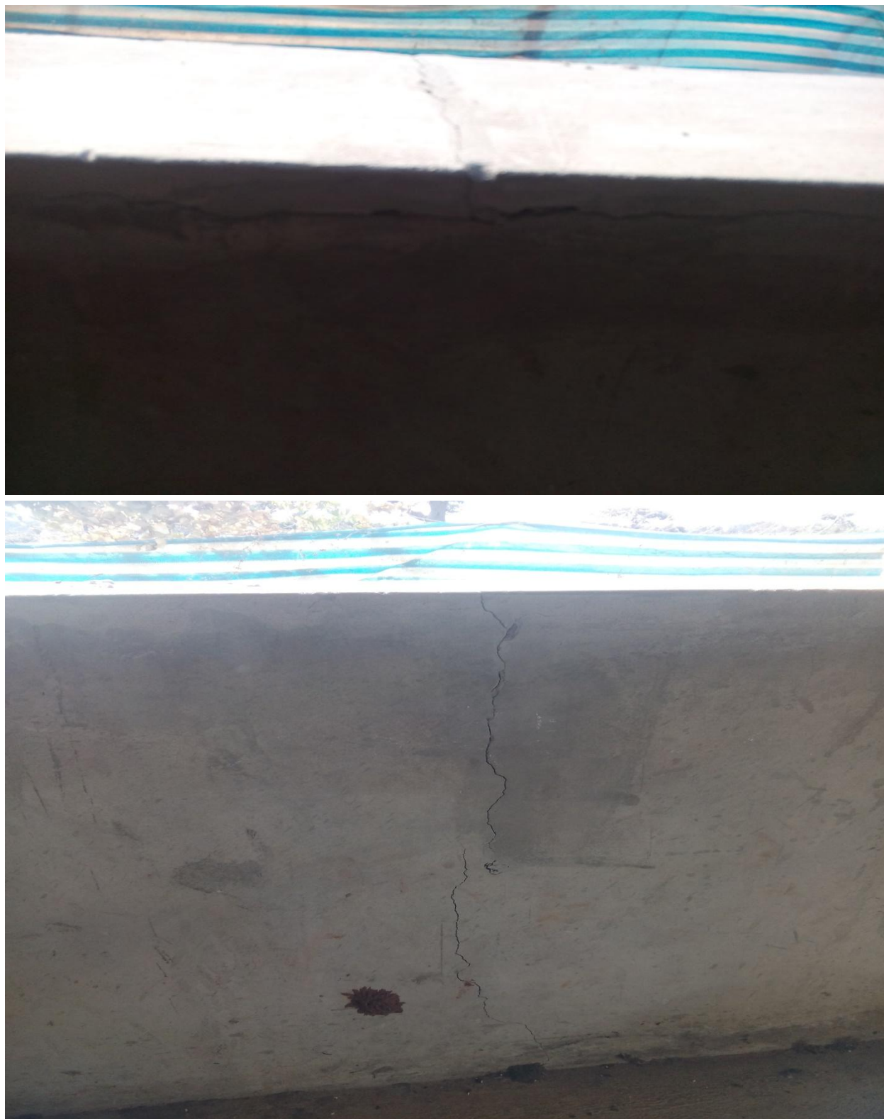
Figura.23. Paredes e arestas com má qualidade.
