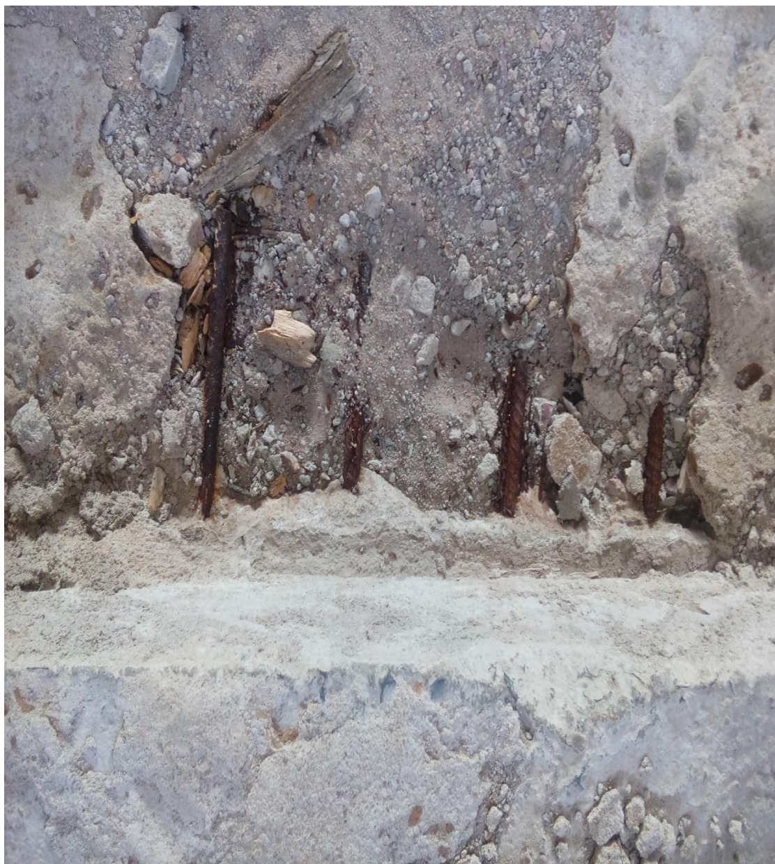
Figura.14. Delaminação causada por corrosão de armaduras.
