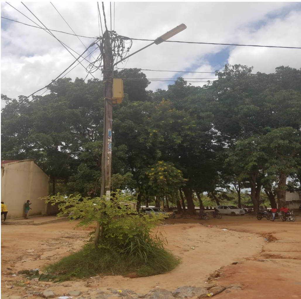
Figura 14: alguns componentes da rede de iluminação Pública do Bairro de Napipineque necessitam da manutenção e inspeção.
