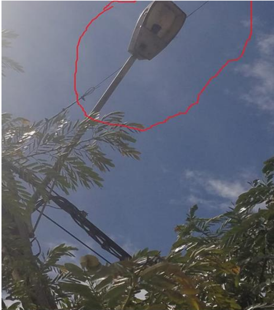
Figura 15: Luminária por falta de Manutenção no bairro de Napipine
