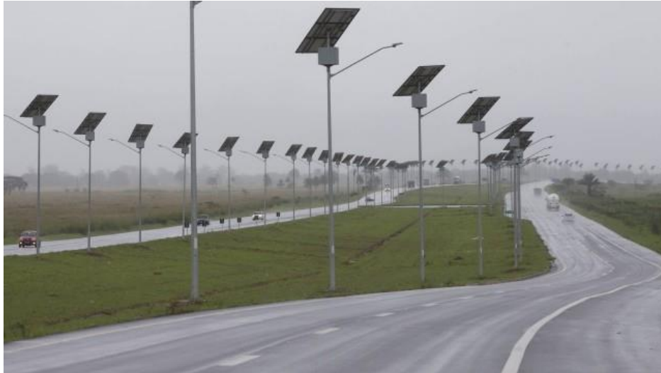
Figura 29. Via pública equipada de postes solares
