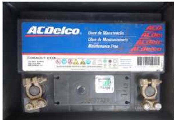
Figura 3: Armário de bateria
