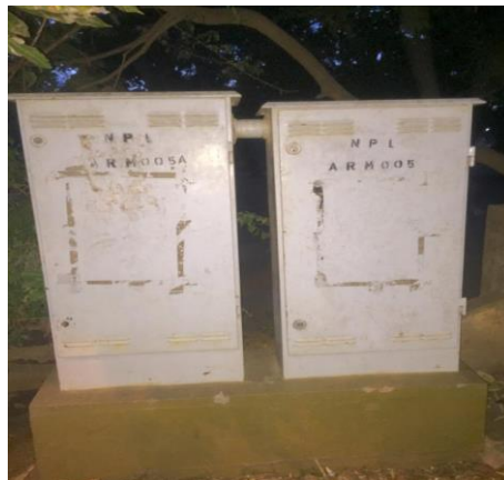
Figura 7 - Armário de Interligação entre as centrais
