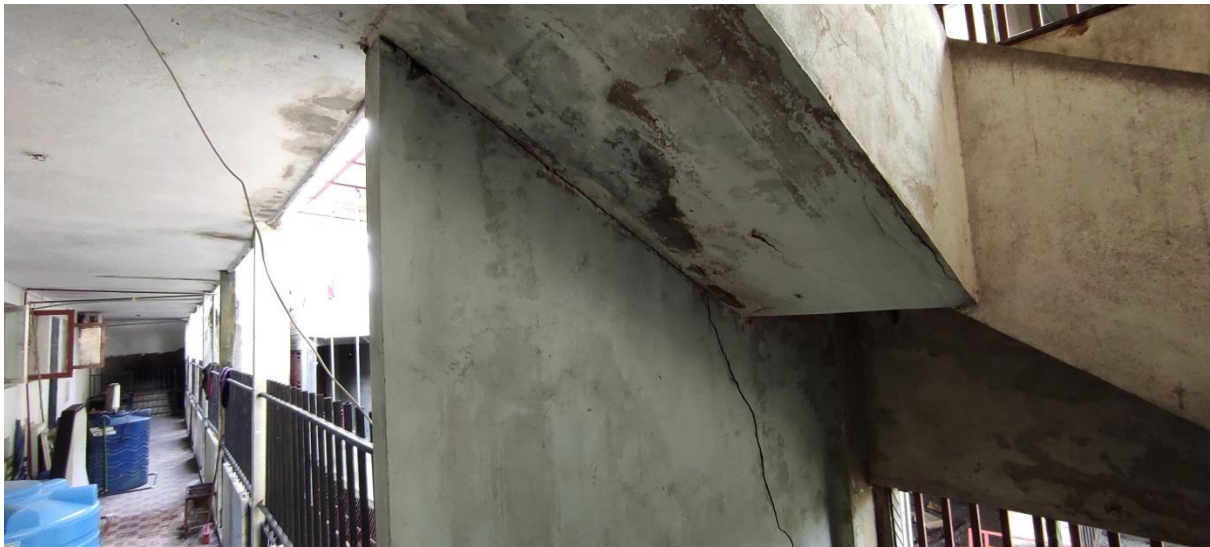
Figura 37: Fissuras nas Alvenarias
