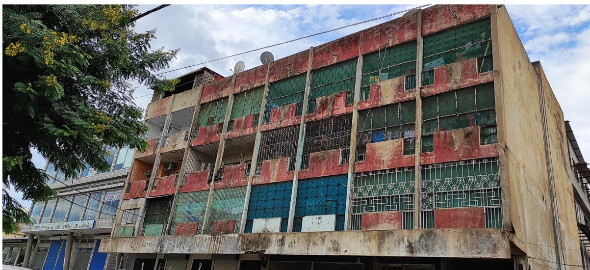
Figura 42: Descascamento de tinta e manchas de umidade nas fachadas.
