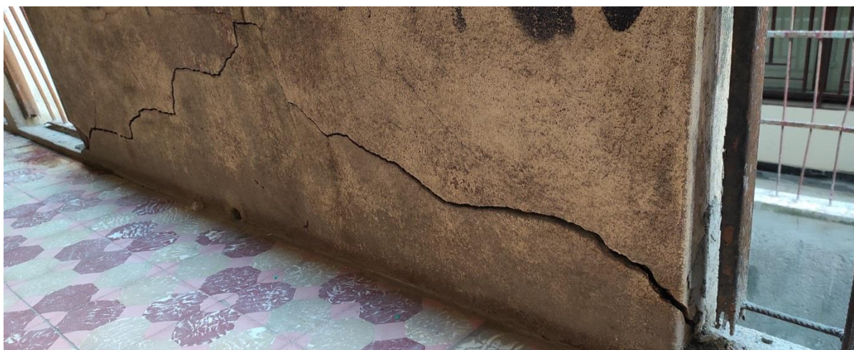
Figure 40: Fissura no Parapeito da Área de Circulação.
