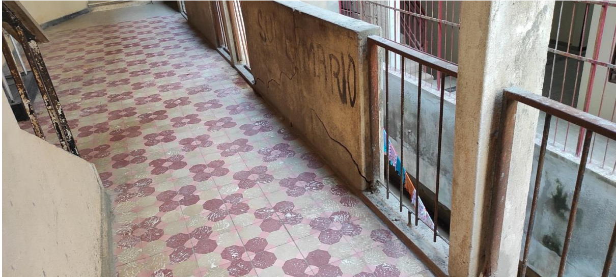
Figura 30: Desgaste do Piso
