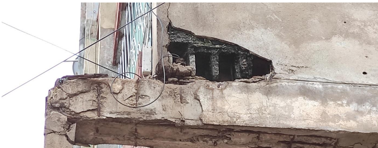
Figura 32: Deterioração do Betão e Armadura Corroída.
