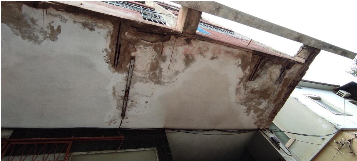
Figura 35: Corrosão das Armaduras na Laje Corrosão de armadura, manchas de humidade e de corrosão (Marrom avermelhadas)
