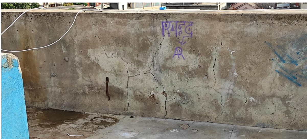
Figure 41:: Fissura no Parapeito no Terraço
