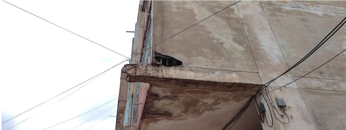
Figura 31: Deterioração do Betão e Armadura Corroída.
