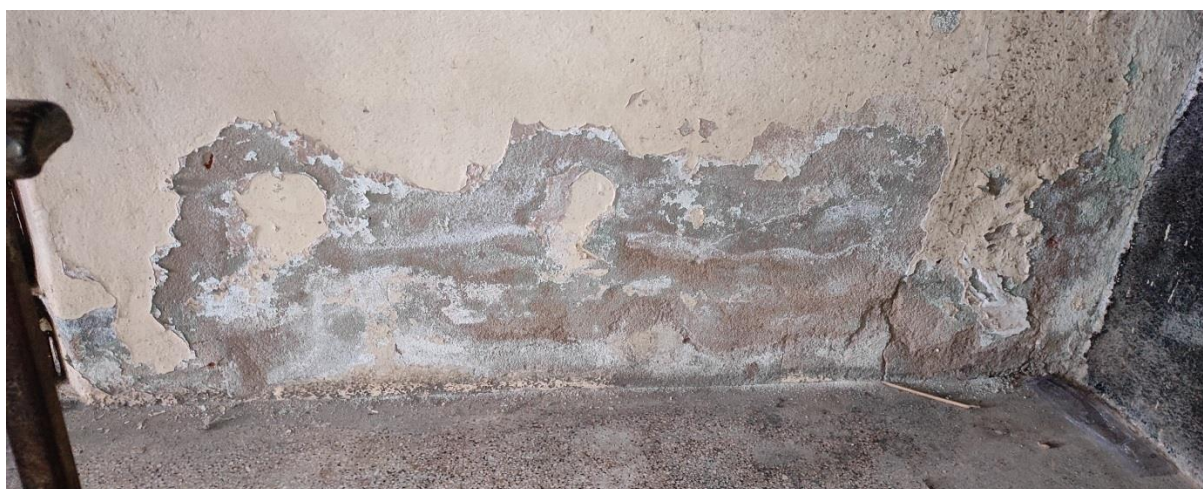
Figure 43: Eflorescências na pintura interna do edifício.
