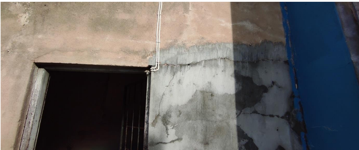
Figura 34: Fissuras nos Lintéis
