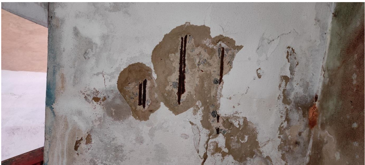
Figura 36: Corrosão das Armaduras na Laje
