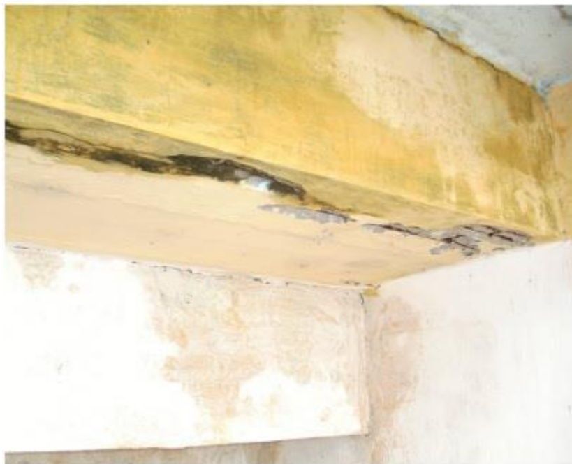
Figura 17: Desagregação do betão.
