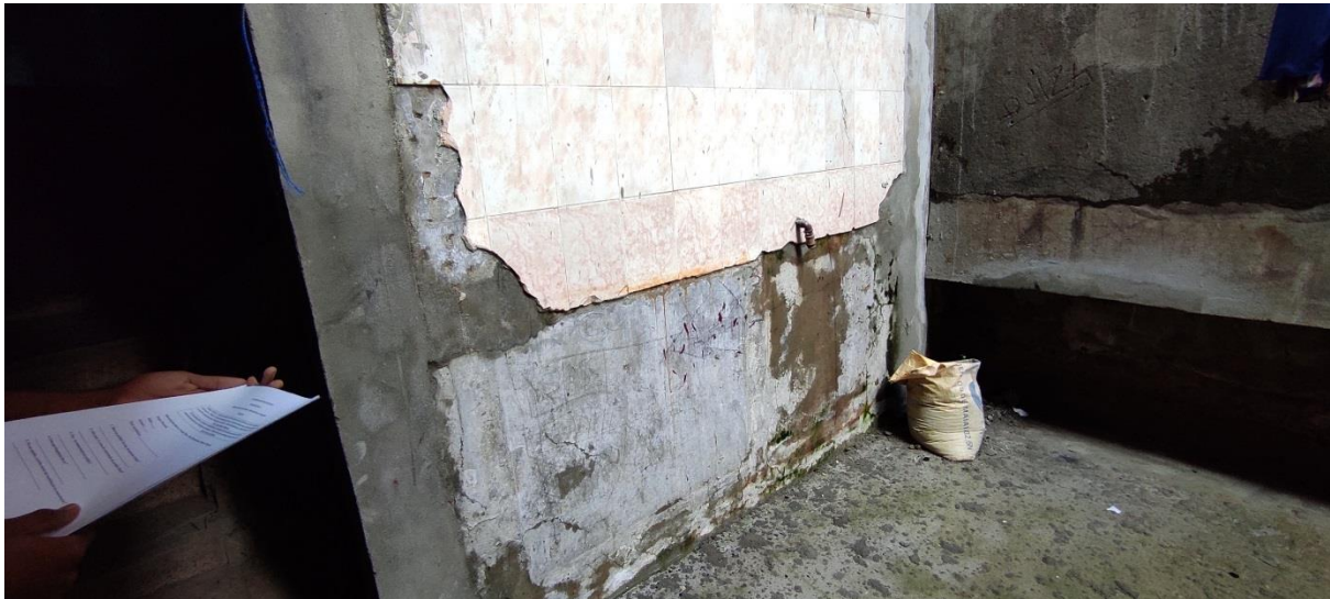
Figura 39: Erosão da Superfície de Revestimento Cerâmico
