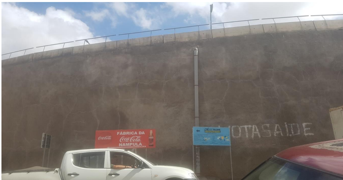
Figura 15: Fissuras viaduto da cidade de Nampula
