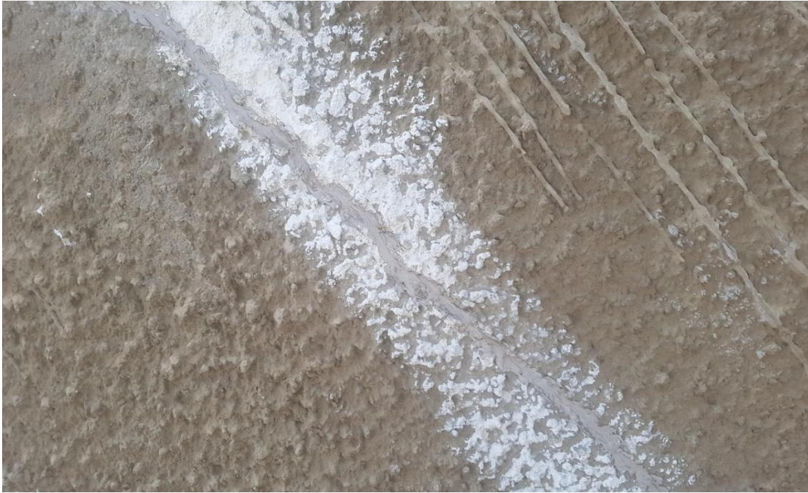
Figura 21:fissura do viaduto reparada com silicone
