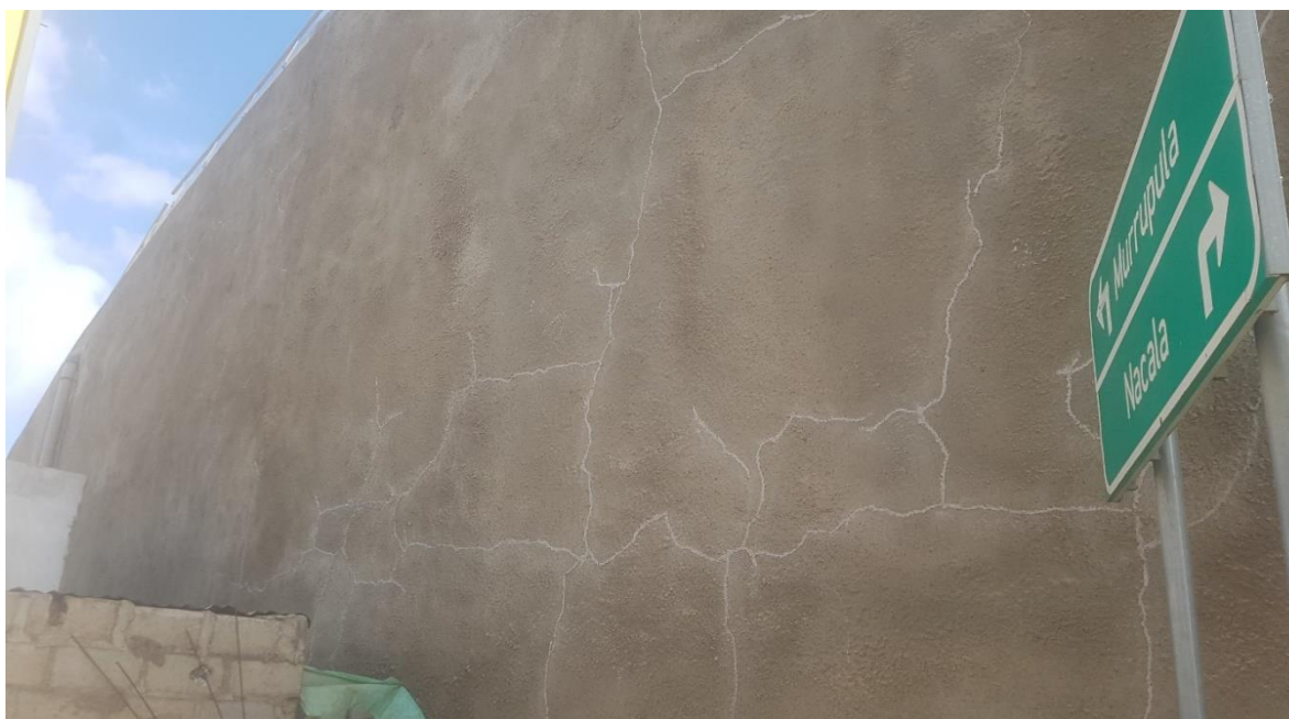
Figura 16: fissuras do viaduto da cidade de Nampula
