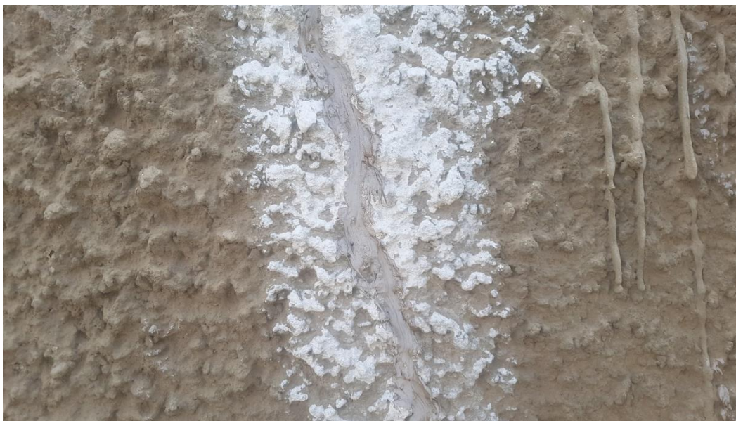
Figura 20:fissura do viaduto reparada com silicone
