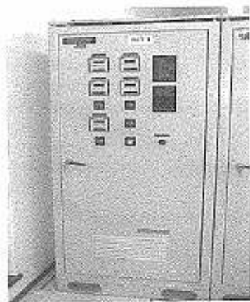
Figura 2.2 – Retificador/carregador de baterias.
