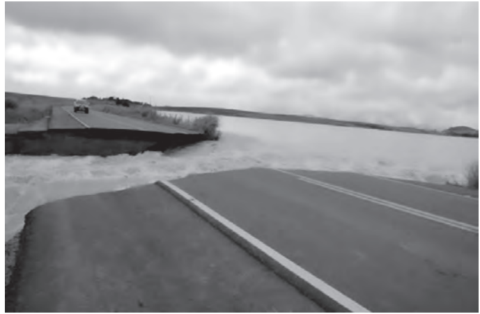
FIG. 15.15 Ruptura de aterro com o rompimento da estrada BR-356, na altura de Campos, no norte fluminense, provocado pela cheia do rio Muriaé
