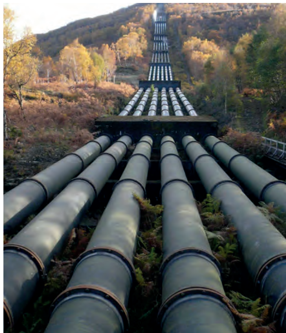
FIG. 15.45 Trecho de oleoduto em superfície
