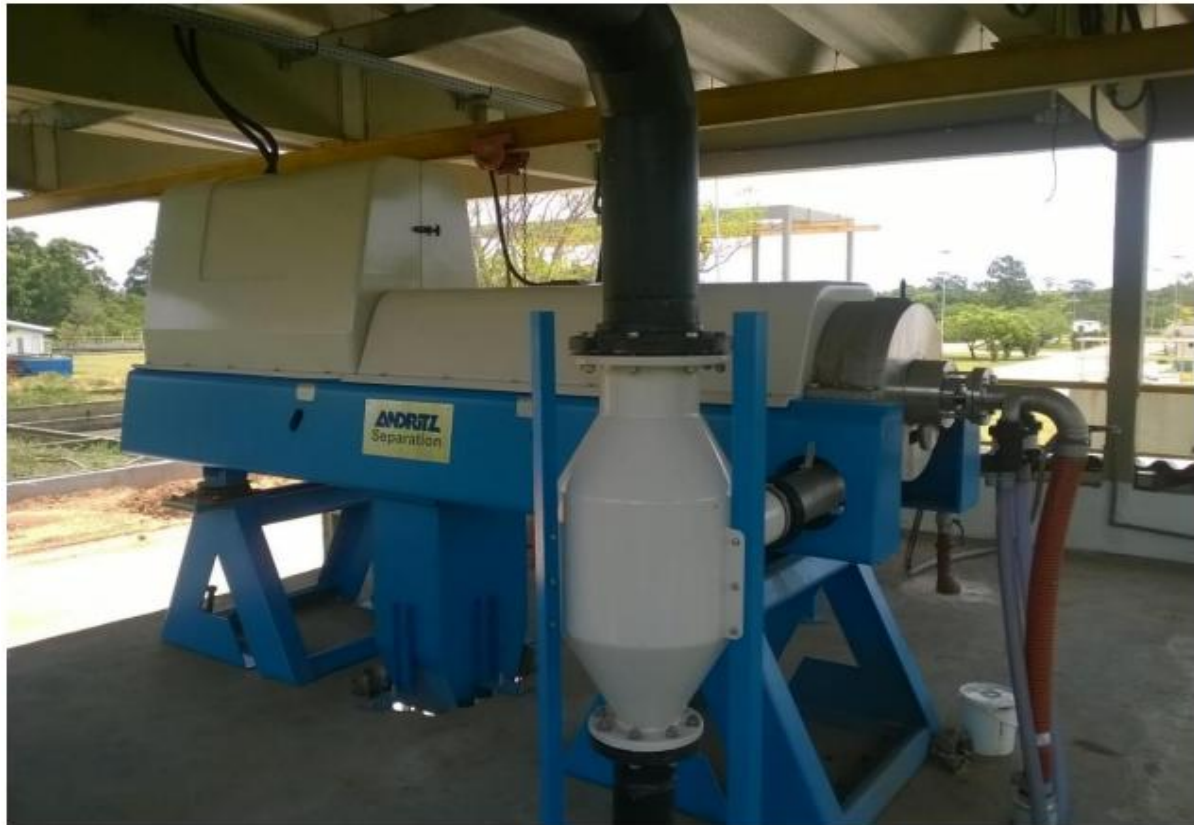
Figura 11- Decanter centrífuga Andritz instalada numa estação de tratamento de esgoto:
