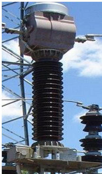
Figura 5: Transformador de corrente. Fonte: (Autor).
