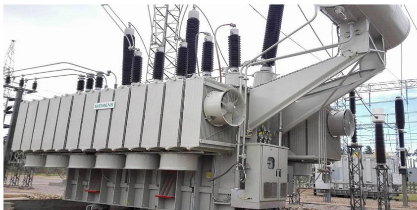
Figura 7: Transformador de potência. Fonte: (Autor).
