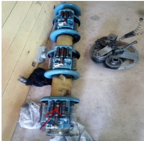
Figura 17: Cumutador de tomadas avariado dum transformador de 66/11 kV.
