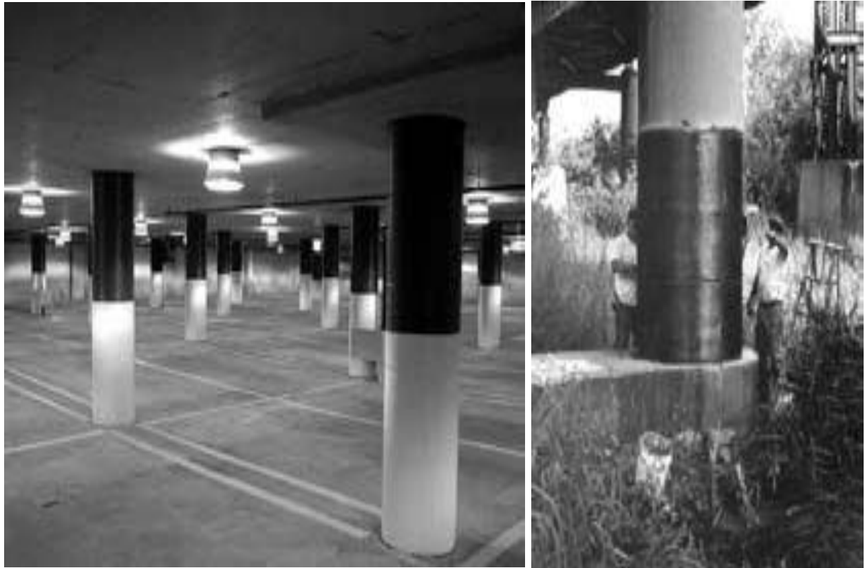
Fotografia 3 – Colunas reforçadas por confinamento para efeitos sísmico (Fonte: Machado, 2010).
