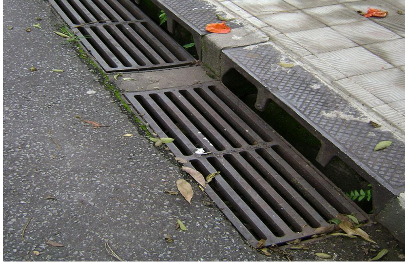
Figura 12: Boca de Lobo Múltipla
