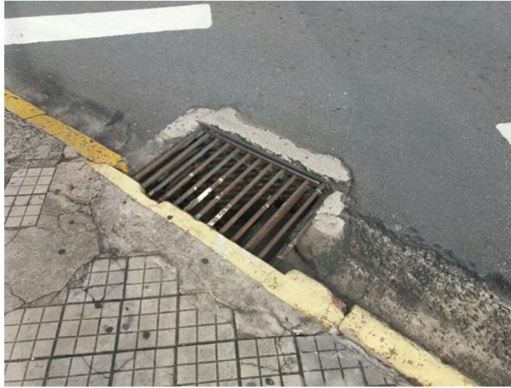
Figura 10: Boca de Lobo com Grelha
