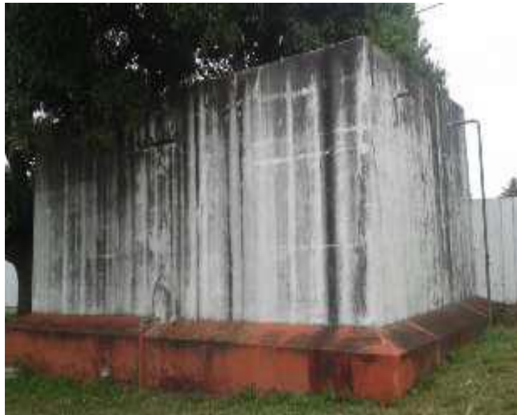
Figura 12: Depósito apoiado dentro da Residência Oficial: fonte autor
