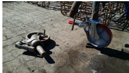
Figura 49 - Protecção Colectiva – Manutenção de Andaimos Fonte: (10181 – Produção e Fornecimento de Barreiras New Jersey)
