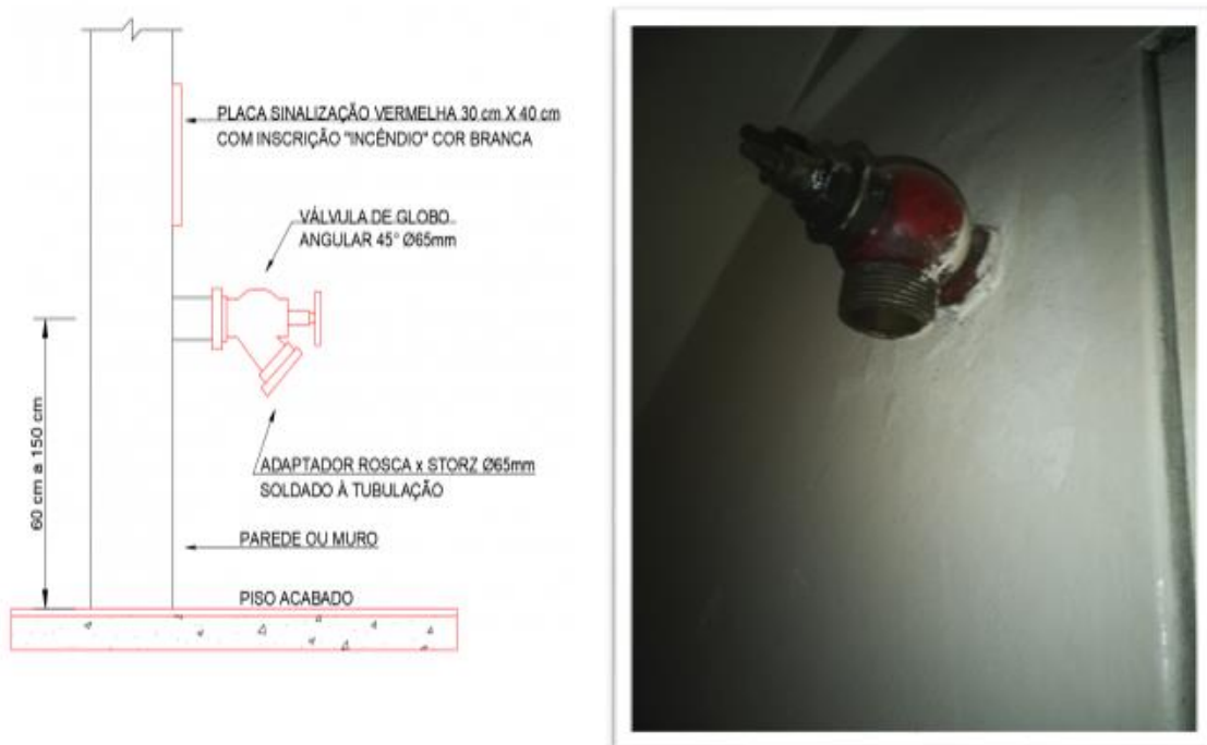
Fig 5: Valvula interna de boca de Incendio
