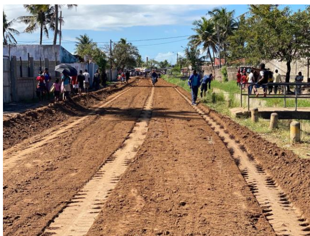
Figura nº 1: Secção transversal inadequada
