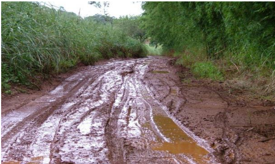
Figura 7: Secção Transversal Inadequada. Fonte: (Fontenele e Junior, 2013)
