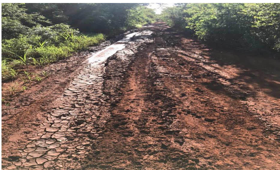
Figura 29: Drenagem Lateral Inadequada Fonte: (Autor, 2020)
