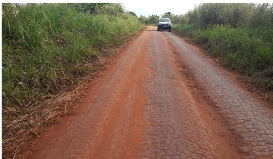
Figura 31: Perda/Segregação de Agregados Fonte: (Autor, 2020)
