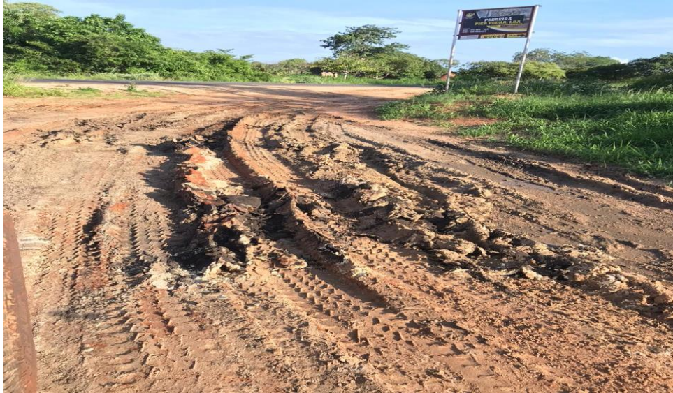
Figura 28: Seção Transversal Inadequada Fonte: (Autor, 2020)
