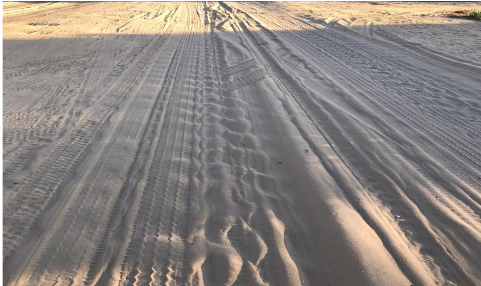
Figura 30: Corrugações/trepidações Fonte: (Autor, 2020)
