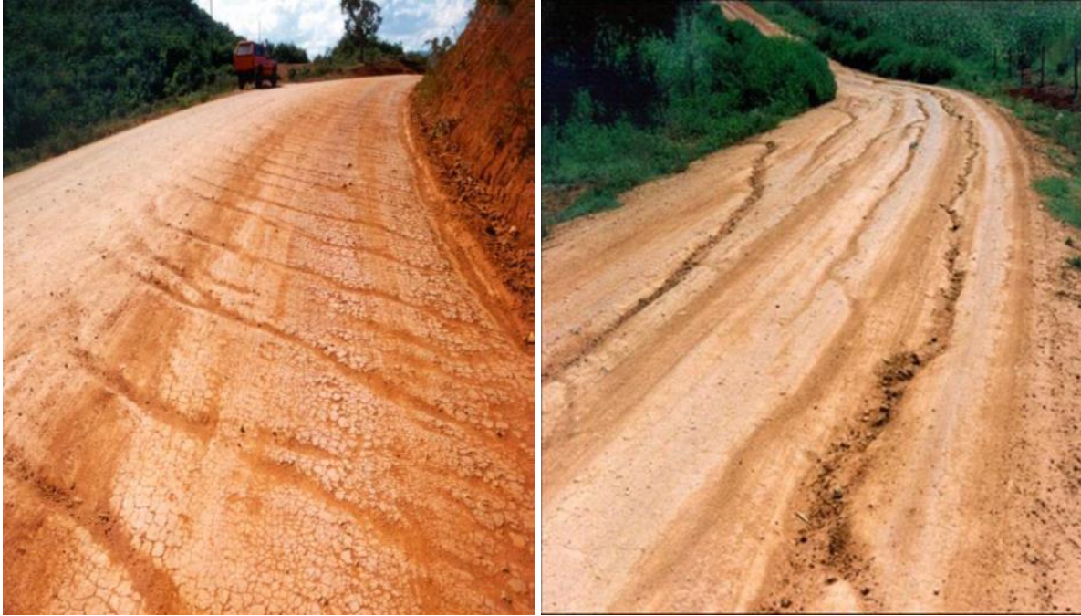
Figura 23: Erosão Transversal e Longitudinal Fonte: (Skorseth e Selim, 2000)
