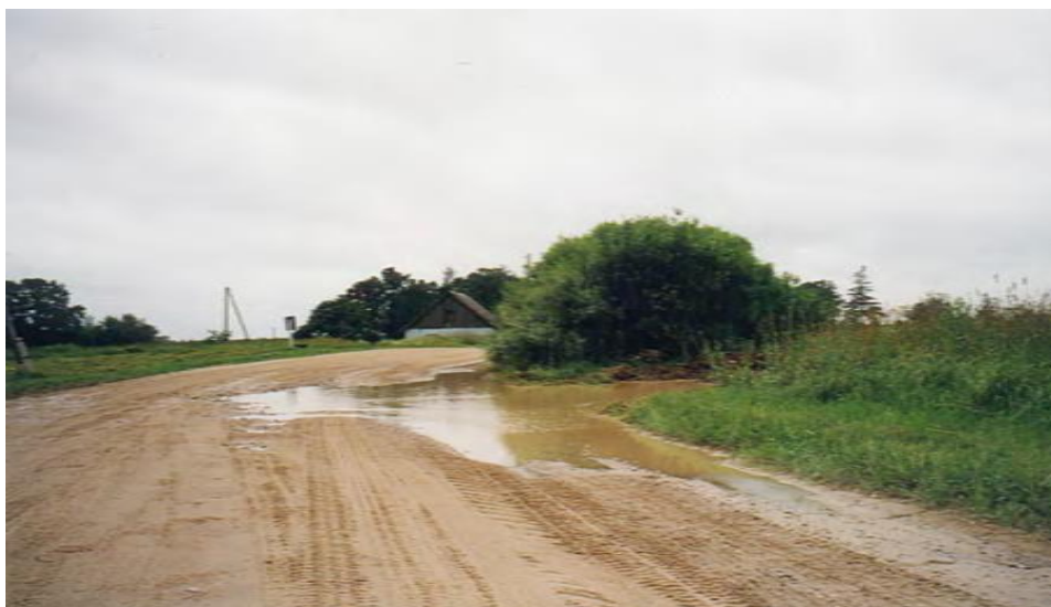
Figura 11: Drenagem lateral inadequada Fonte: (Skorsest e Selim, 2000)
