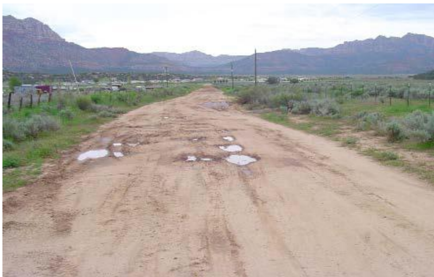
Figura 20: buracos Fonte: (Skorseth e Selim, 2000)
