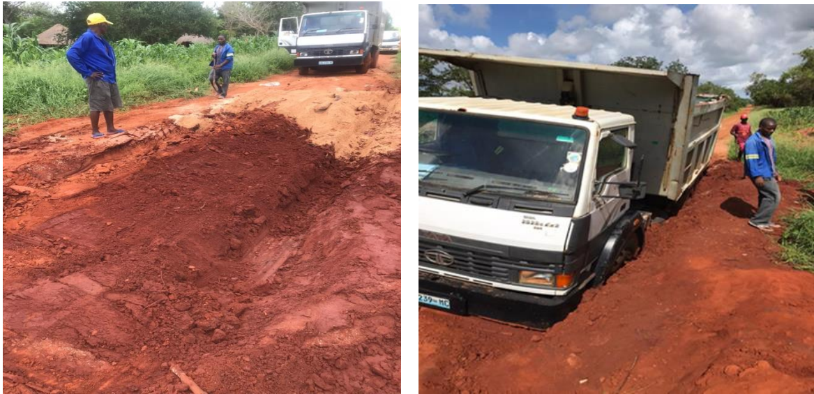
Figura 34: Afundamento de Trilhas de Rodas Fonte: (Autor, 2020)
