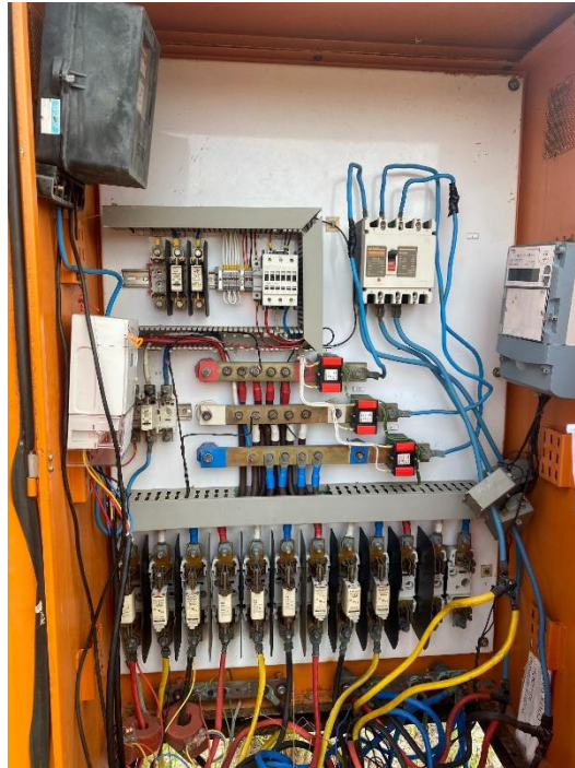
Figura 9: Quadro de Geral de Baixa Tensão
