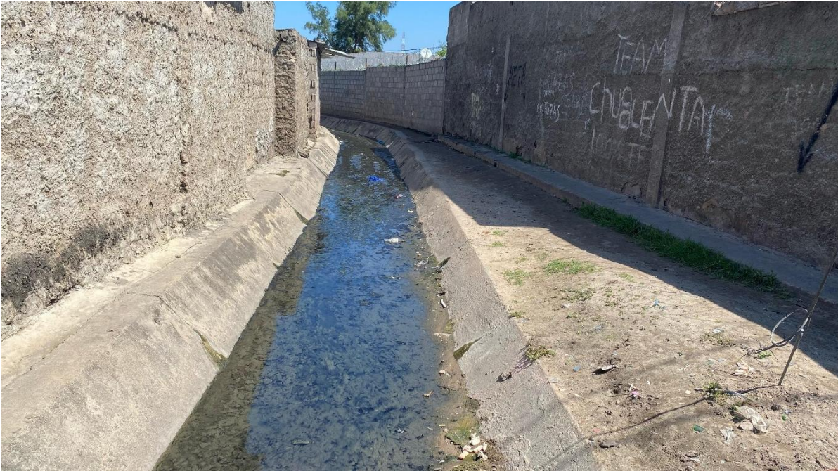
Figura 11. Vala de Drenagem, bairro da Mafalala, faz cruzamento com a R. Eusébia da Silva Ferreira. (2024). Fotografia pessoal
