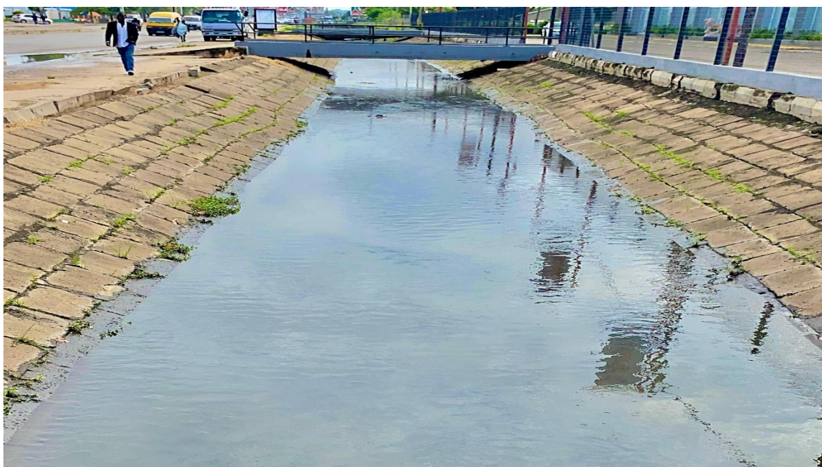
Figura 8. Valas de drenagem Localizada Av.Acordos de Lusaka. (2024). Fotografia pessoal
