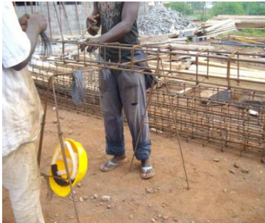
Figura 14: A Imprudência dos Trabalhadores no Manuseio de Varões sem Luvas
