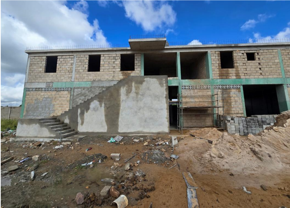
Figura 13: Entulho Desorganizado e sem Nenhuma Sinalização no Estaleiro da Obra
