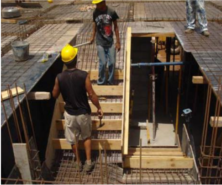
Figura 12: Falta de Uso de Equipamento de Protecção
