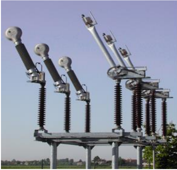
Figura 7: Seccionador de Alta tensão. (antes da Instalação)
