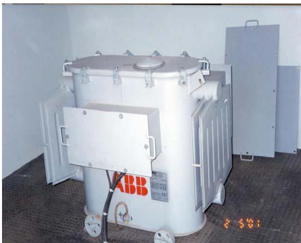
Figura 12: Transformador de Serviços Auxiliares
