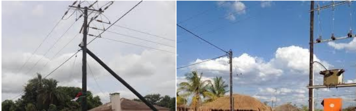
Figura 12- Rede de distribuição em BT
