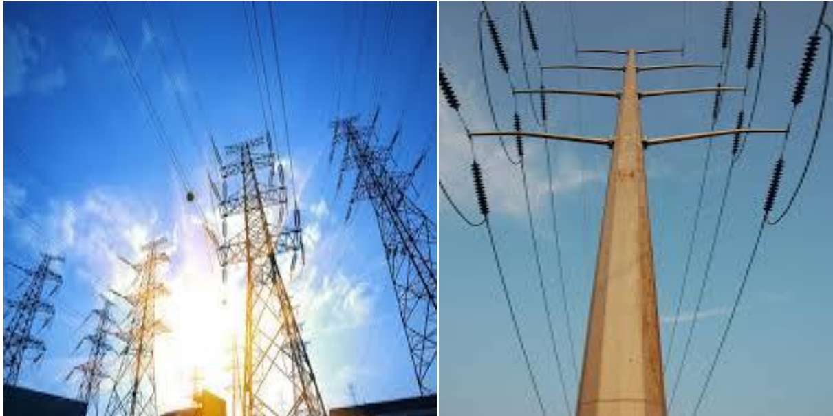
Figura1-Linha de transmissão de energia
