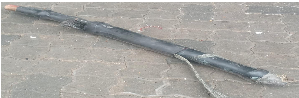
Figura 2: Caixas de junção mal manufacturada pelos técnicos
