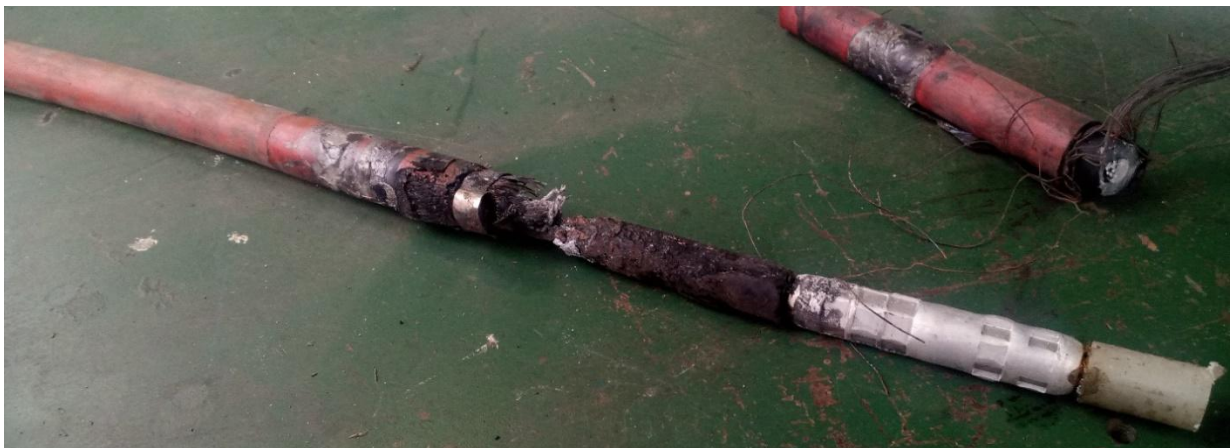
Figura 4: caixas desfeitas onde se notou a falha técnica na Manufatura
