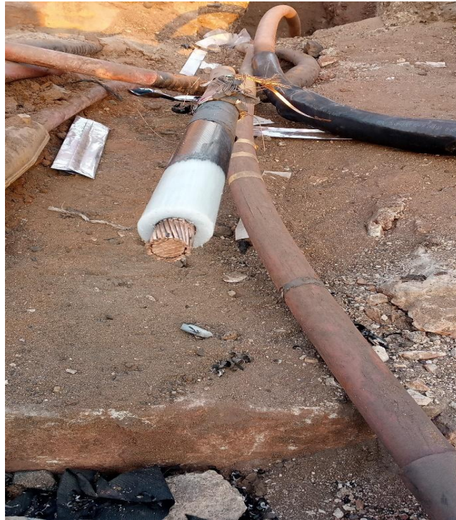
Figura 3: Cabo XLPE 1P 240 mm 2 de uma das linhas de 33 KV
