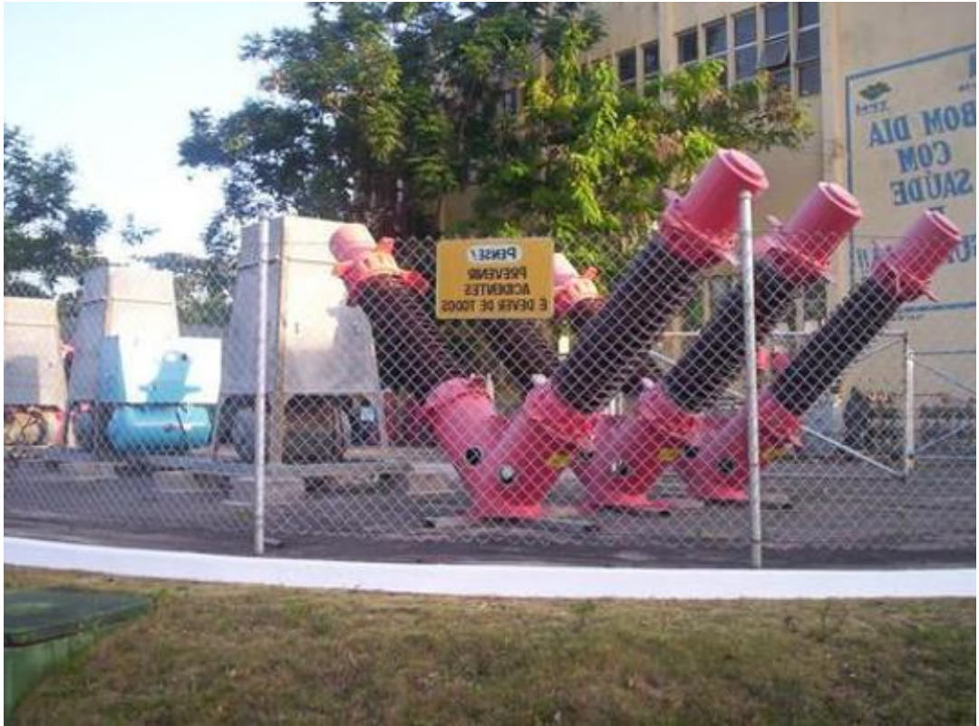
Figura 5. Subestação Abaixadora Fonte: (Muzy, 2012 p. 10)
