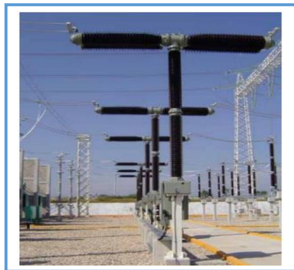
Figura 23. Disjuntores de uma Subestação Eléctrica de alta tensão
