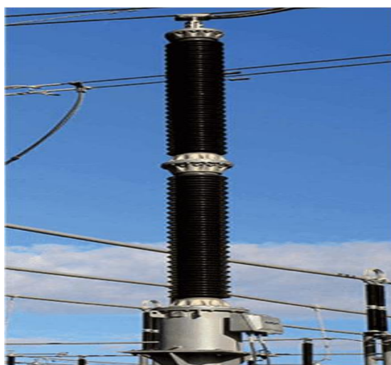
Figura 25. Transformador de tensão
