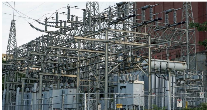
Figura 4. Subestação Elevadora Fonte: (HM Sistemas, 2024)
