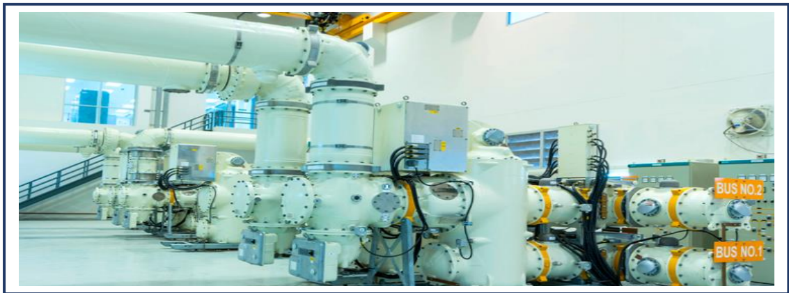
Figura 3. Subestação de Manobra Fonte: Marques, S. (s.d.).
