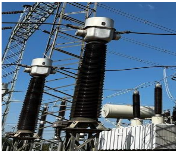
Figura 24. Transformador de corrente
