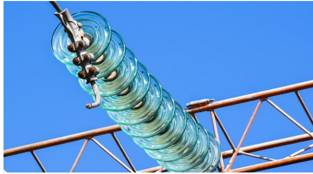
Figura 13. Cadeias de isoladores sujeitas a esforços Horizontais
