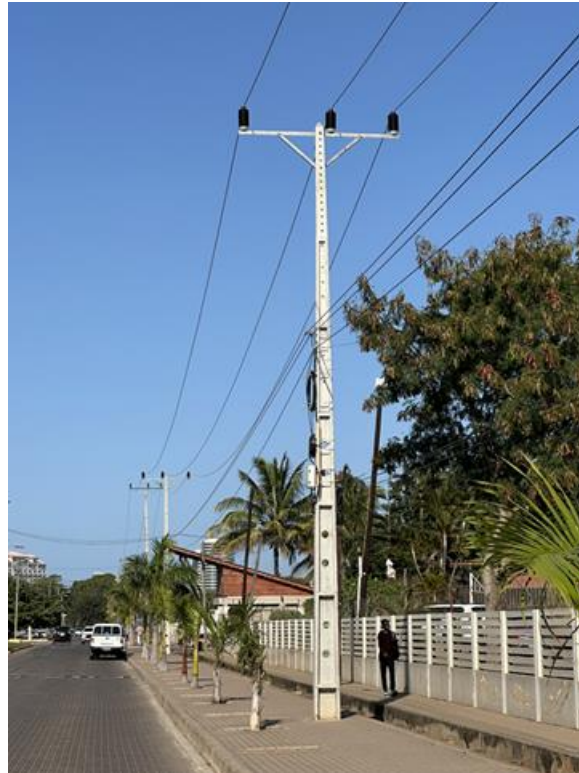
Figura 3 - Poste de alinhamento em betão
