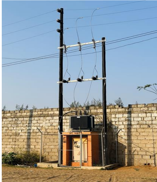
Figura 1 - Posto de transformação
