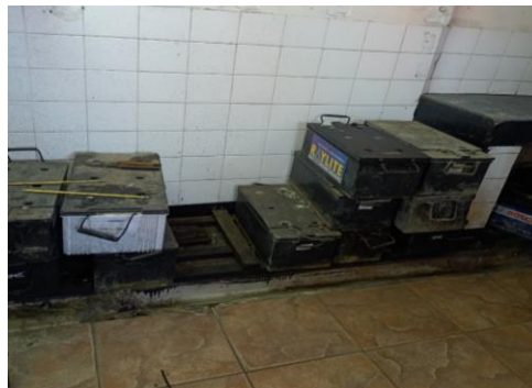
Figura 12: Baterias de chumbo-ácido armazenadas em estratos de madeira da EMTPM
