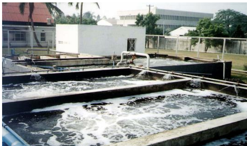
Figure 7. Planta de lodo ativado para tratamento de esgoto. Fonte: Jern, (2006).
