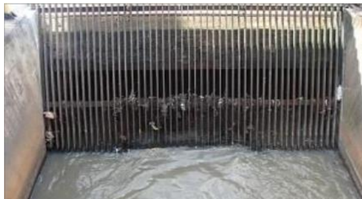
Figura 3. Grade de contenção de uma estação de tratamento. Fonte: Marcondes (2012).
