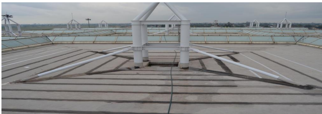
Figura 11 - Estado da antiga membrana impermeabilizante
