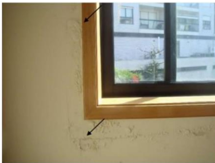
Figura 3 - Fenómeno da humidade por Infiltração (Fonte: Marinho, 2014).
