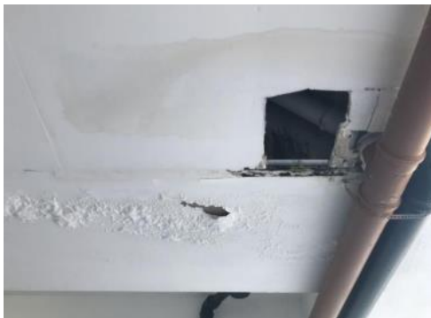
Figura 7 - Vazamento da tubulação em foro de gesso (Fonte: Marinho, 2014)
