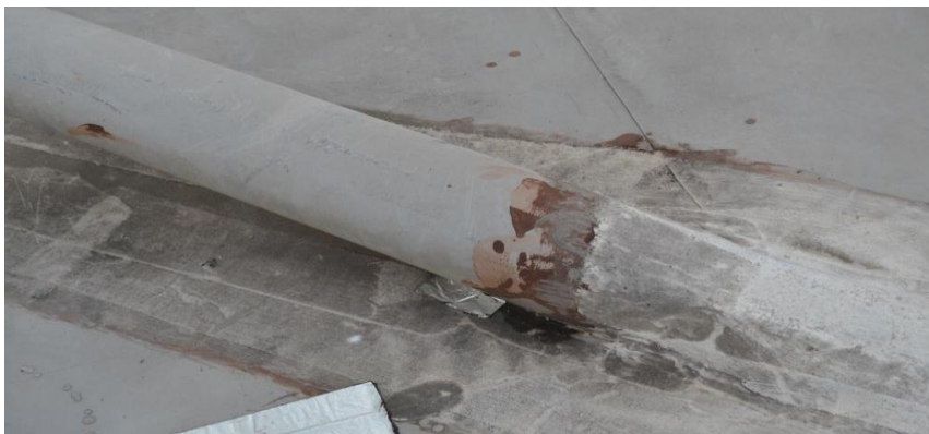
Figura 12 – Corrosão dos perfis metálicos
