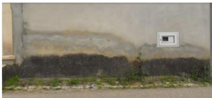
Figura 5 - Humidade ascensional (Fonte: Sika,2017)
