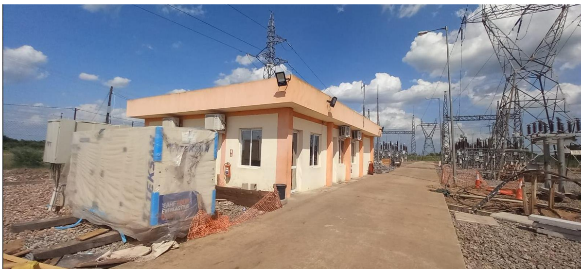
Imagens da Subestação de Nhamatanda
