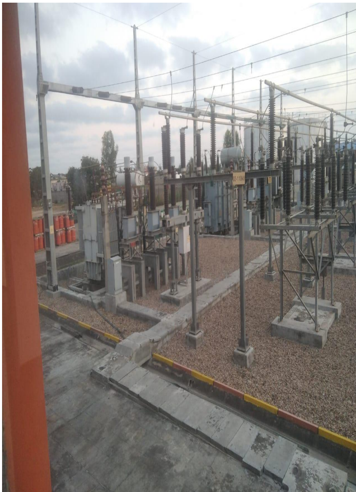
Imagem da Subestação da Munhava
