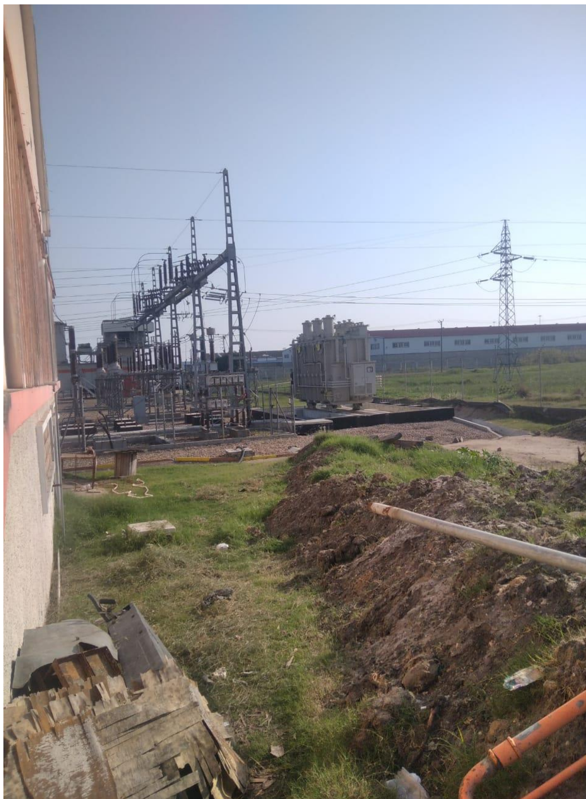
Imagem da Subestação da Munhava
