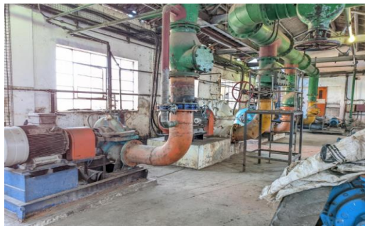
Figura 16: casa das bombas.
