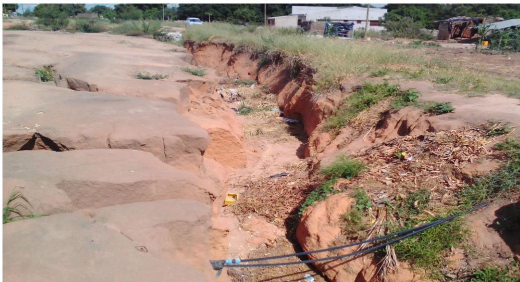
Figura 8: Degradação de via de acesso devido a erosão de solos.
