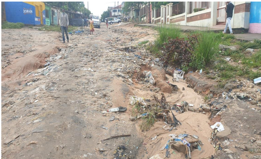
Figura 30 - Ponto de Erosão na rua estudo
