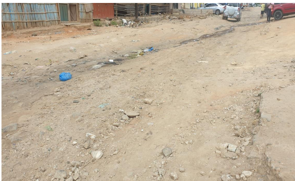
Figura 29 - Segmentos da estrada com segregação de agregado na rua em estudo
