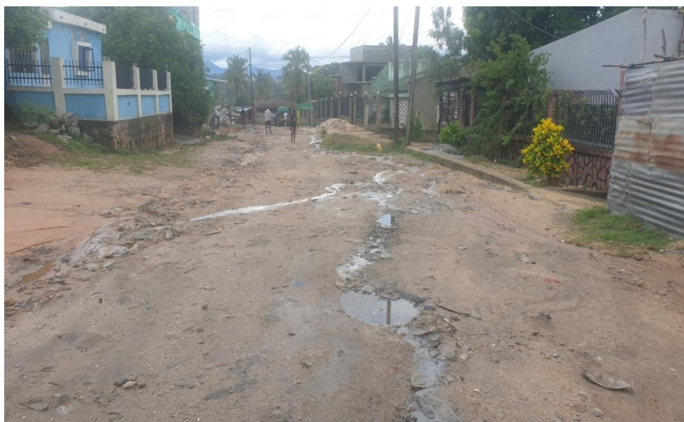
Figura 27 - Estrada sem dispositivos de drenagem adequados, provocando o escoamento da água pelo meio da via
