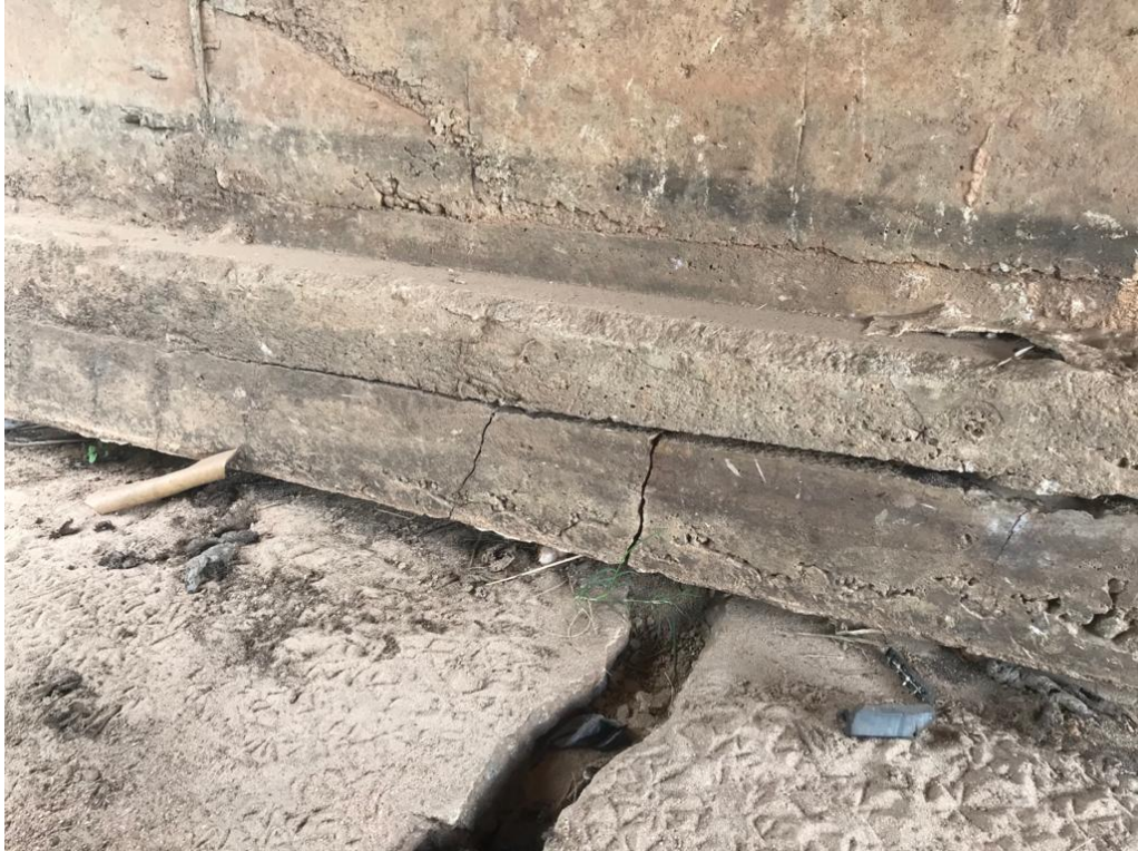
d) Ruptura da sapata de fundação
