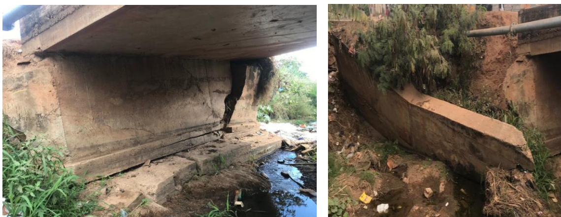
Figura 21: ruptura do encontro da ponte
