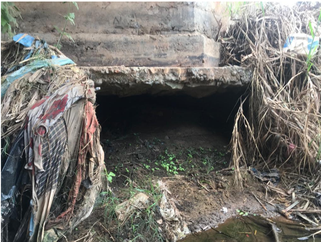
c) Erosão terreno de fundação
