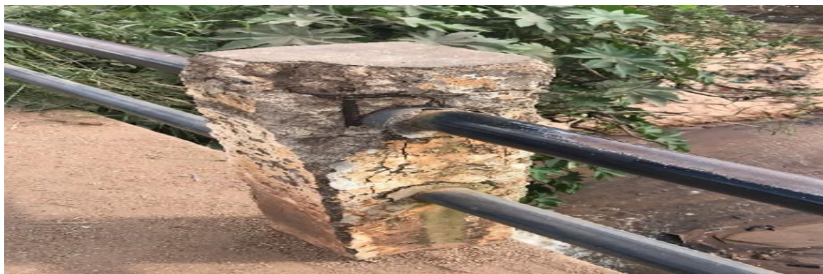
Figura 20: carbonatação do betão
