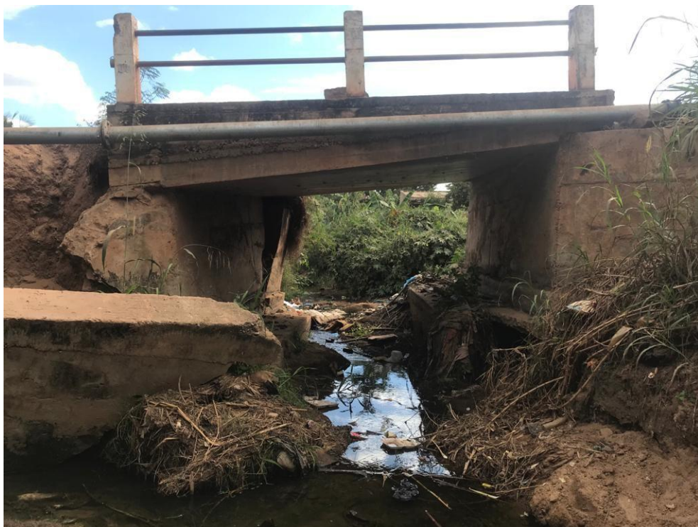
f) Deformações excessivas, agravado com recalque de fundação do encontro
