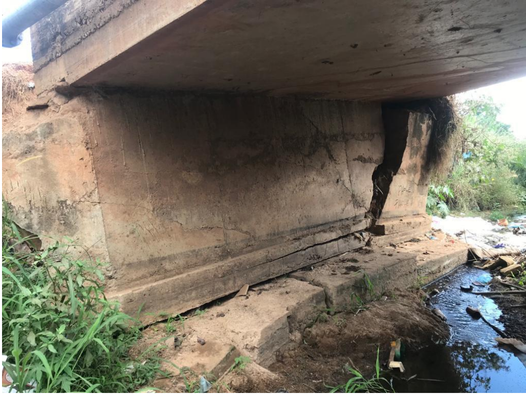
b) Ruptura do encontro da ponte
