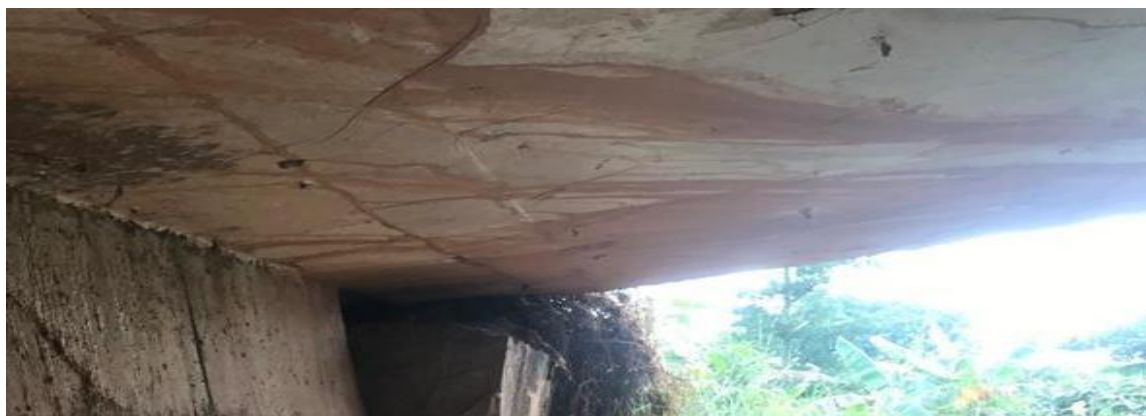
Figura 18: Lixiviação do betão na parte inferior do tabuleiro
