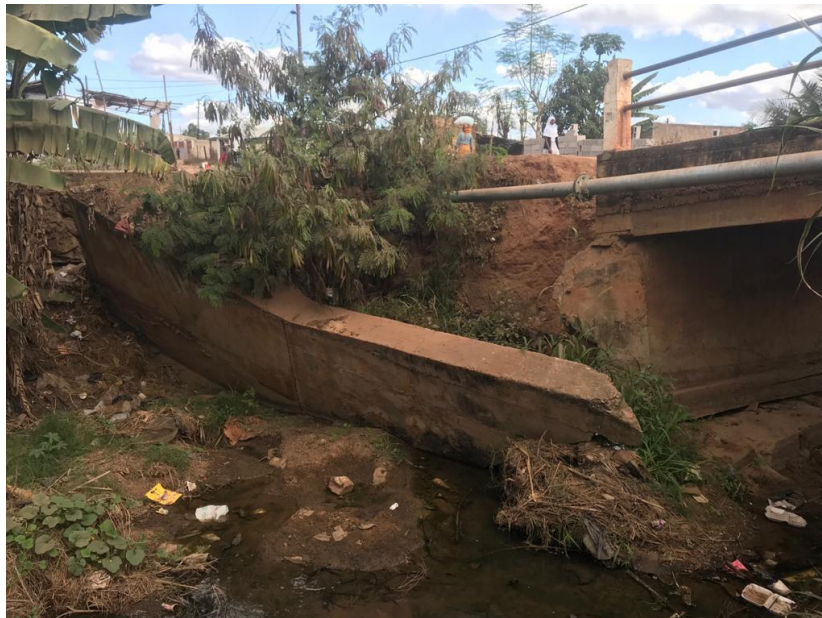
a) Ruptura total e tombamento de muro de ala e sem reposição ao longo do tempo.
