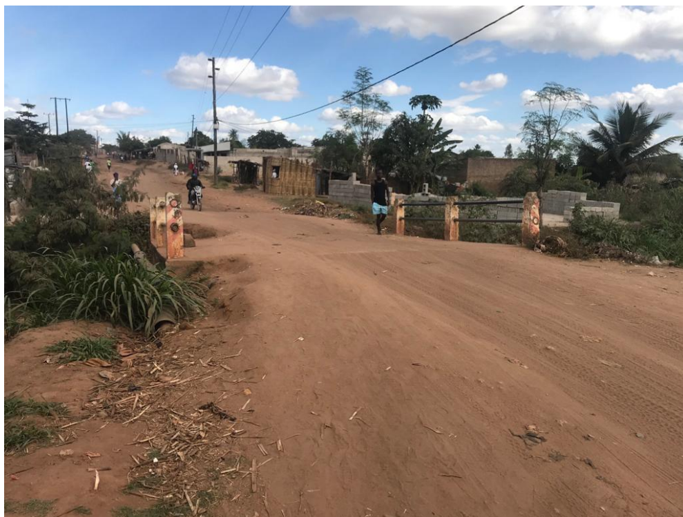
g) Guarda corpo sem pintura
